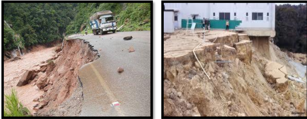
Figura N°01. Deslizamiento de tierra. (Falla en taludes)
