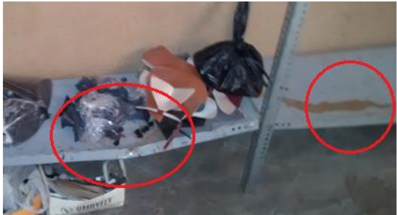
Figura 38. Cuerpos de estantes en mal estado
