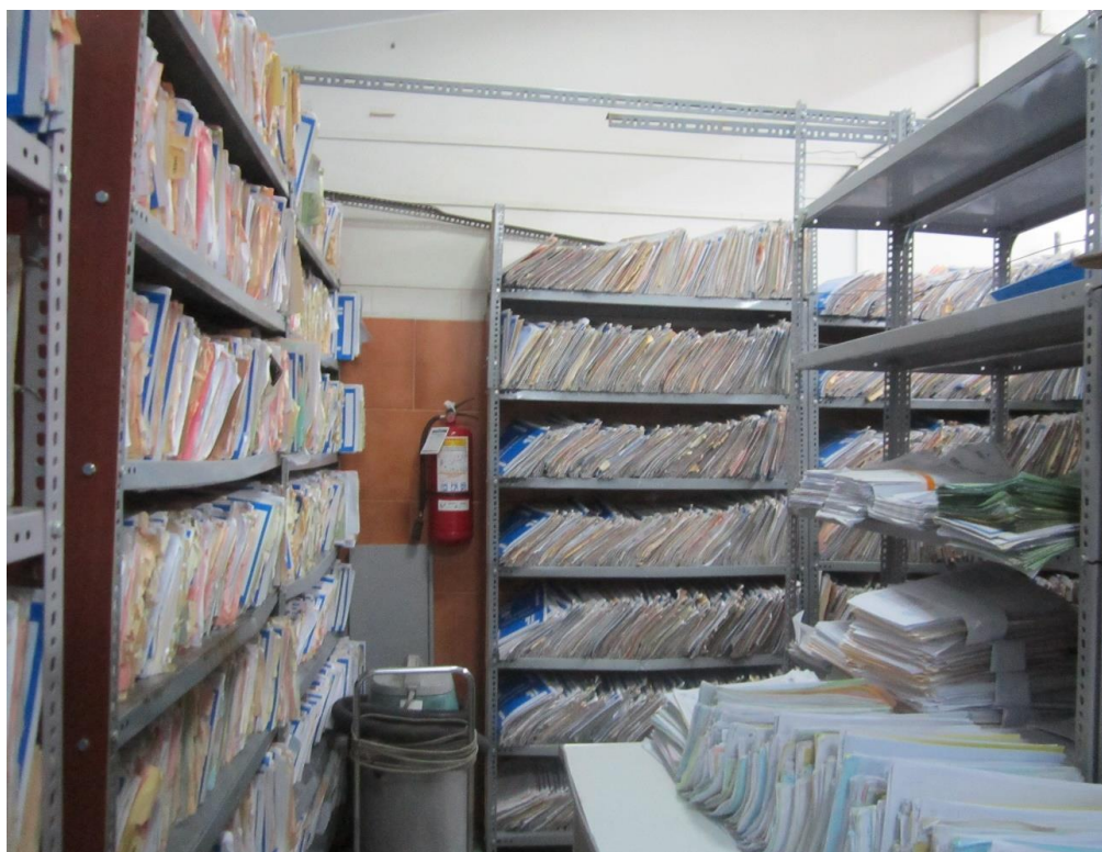
Figura 20. Extintores cerca a anaqueles de historias clínicas
