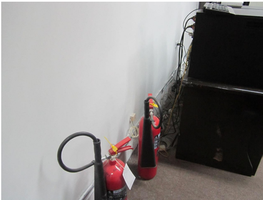
Figura 24. Extintores en Data Center
