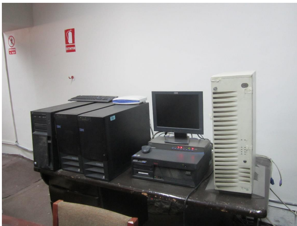
Figura 22. Ausencia de señalización en Centro de Cómputo
