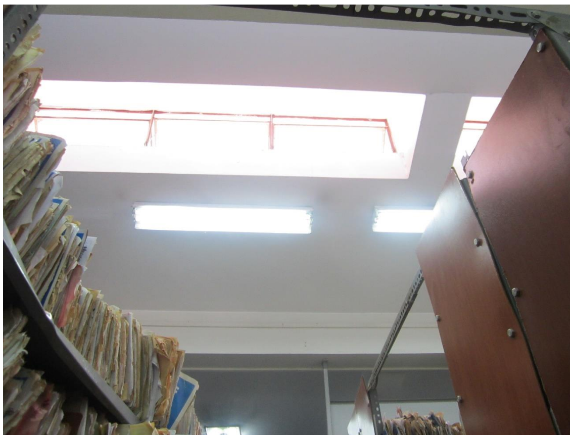
Figura 16. Ductos de ventilación natural en el Archivo de Historias Clínicas
