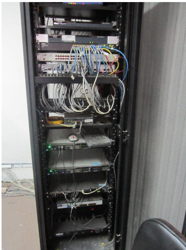
Figura 23. Necesidad de señalización en Data Center
