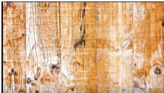
Figura N° 8: Mohos blanco en la madera. (Arbelo, A. y Garbuyo, E. 2012)
