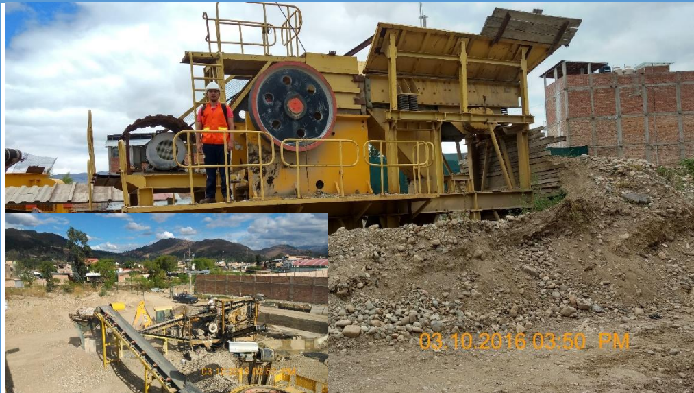
Figura 3.7: Triturado del concreto reciclado en la chancadora de quijada (primaria), para descender a la chancadora de cono (secundaria).
