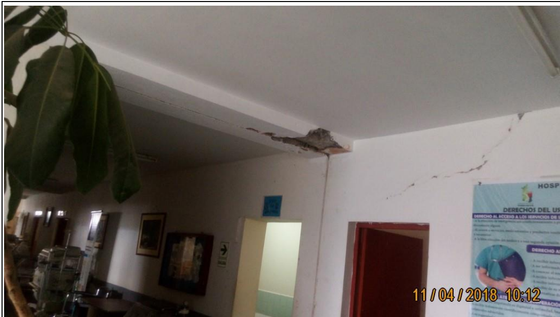
Foto N° 11: Elementos estructurales deteriorados
