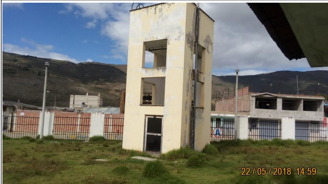
Foto N° 33: deficiencias en los acabados del reservorio elevado
