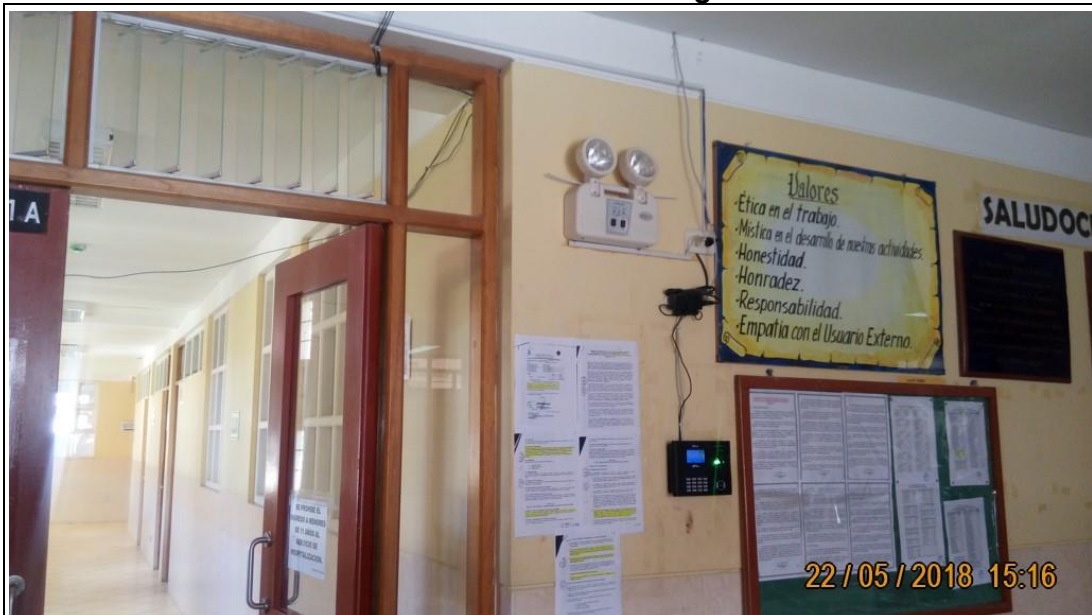
Foto N° 36: Luces de emergencia
