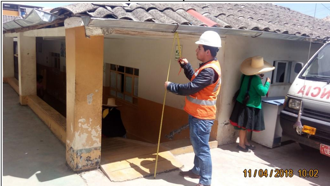
Foto N° 14: Incumplimiento de procesos constructivos
