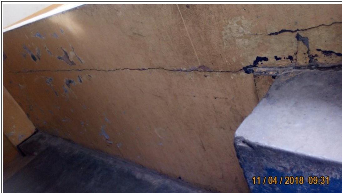
Foto N° 6: Grietas en muros
