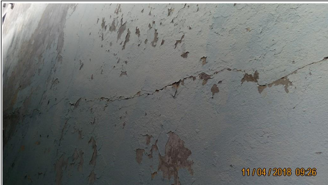
Foto N° 5: Grietas en las estructuras
