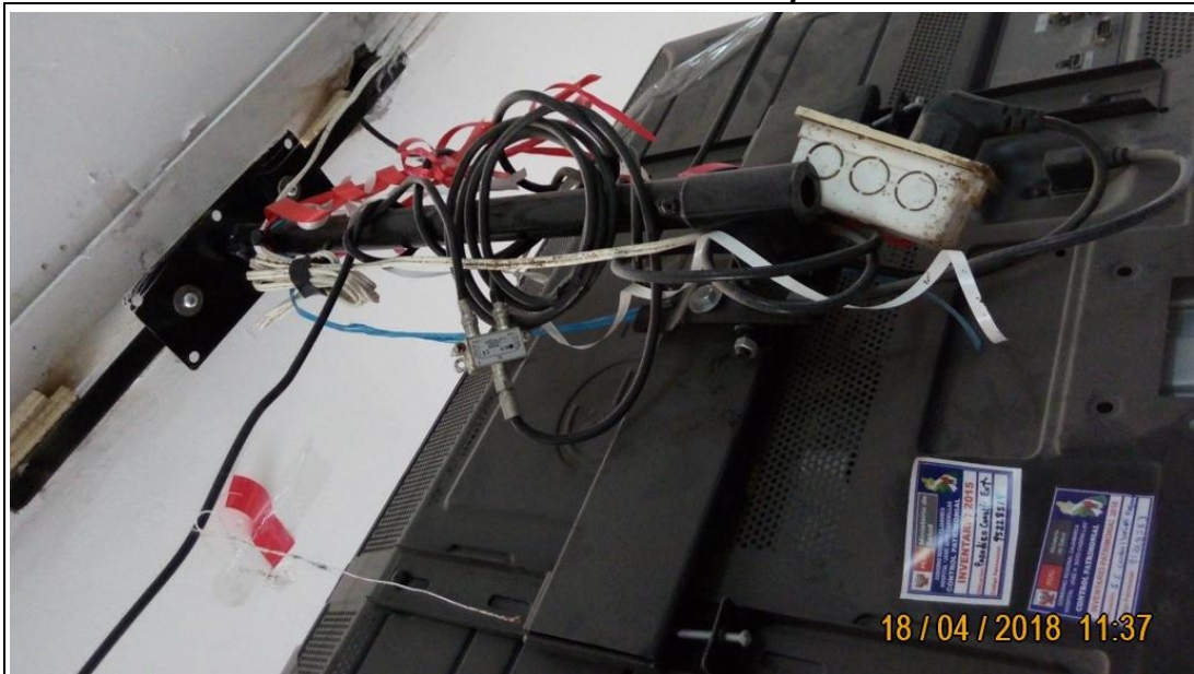
Foto N° 23: Cables eléctricos expuestos
