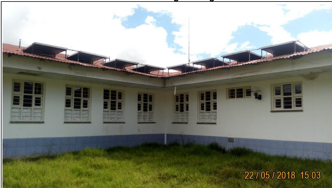
Foto N° 35: Fugas de agua
