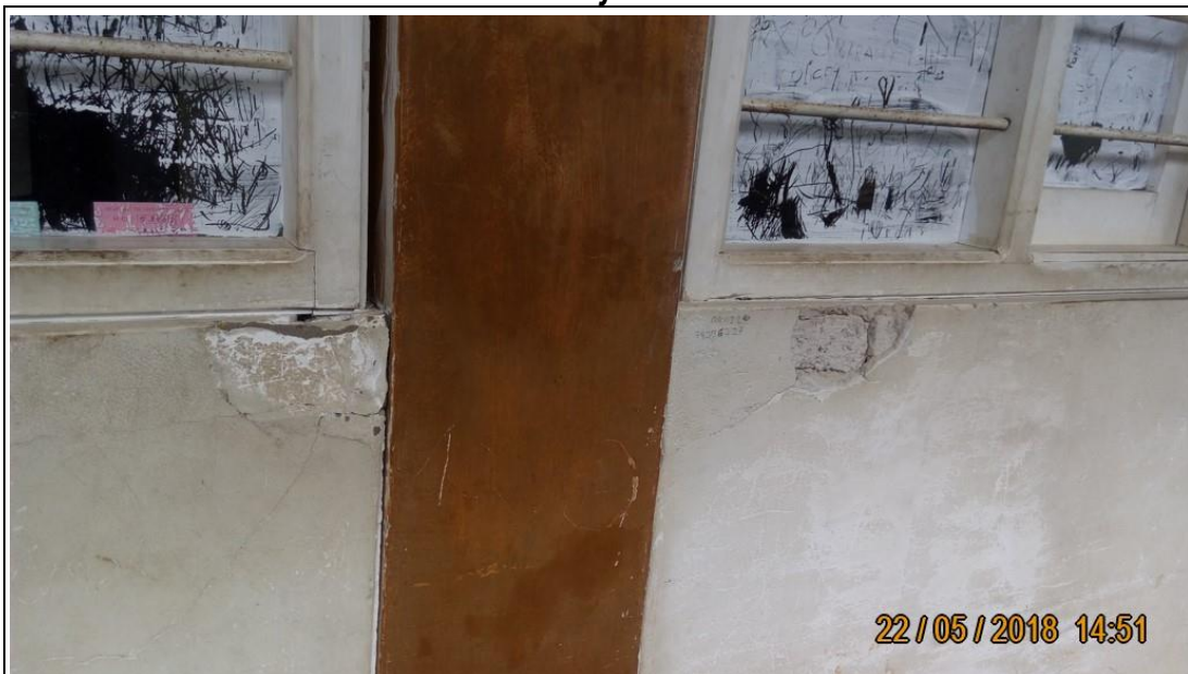
Foto N° 32: Tarrajeo en mal estado
