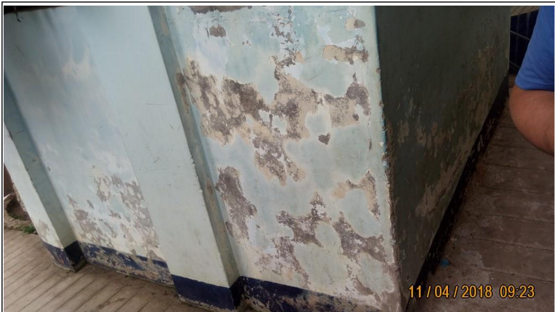
Foto N° 4: Humedad en las estructuras
