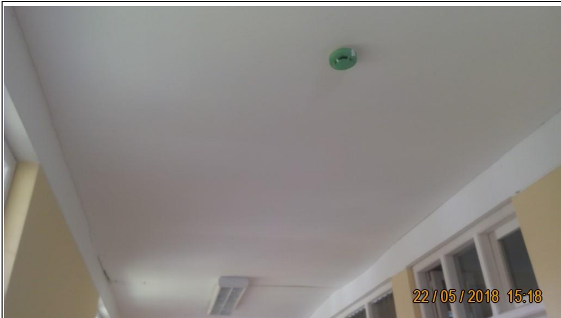
Foto N° 37: Detectores de Humo
