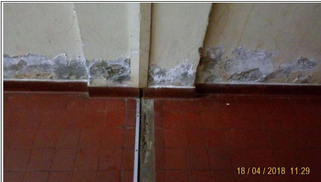
Foto N° 21: Humedad en interior de las edificaciones
