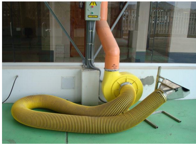
FIGURA N° 04: EXTRACTOR DE GASES
