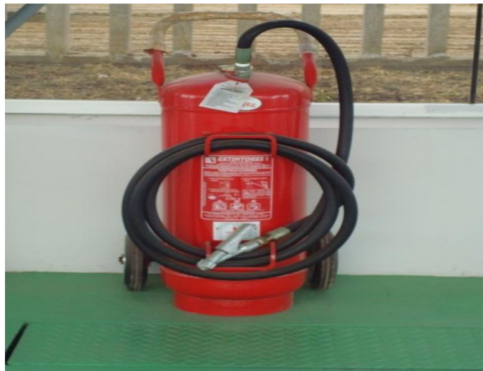
FIGURA N° 11: EQUIPO DE SEGURIDAD: EXTINTOR PQS
