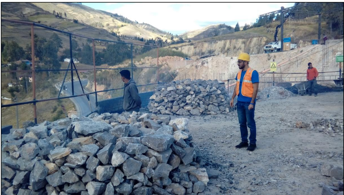
Figura 52. Carguío de hornos de calcinación.
