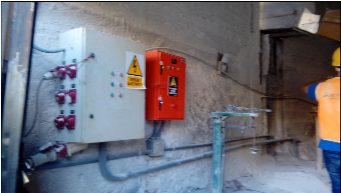
Figura 56. Zona de abastecimiento de energía al hidratador.
