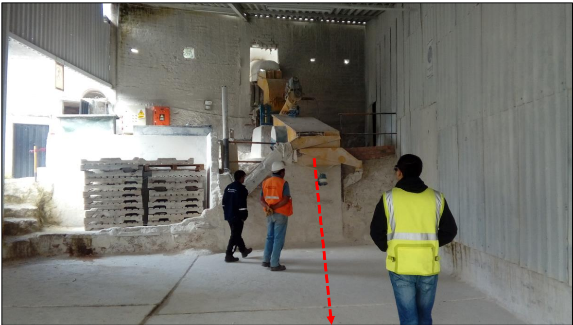
Figura 28: Dirección de la Faja transportadora que conectará la zaranda vibratoria con el silo de almacenamiento.
