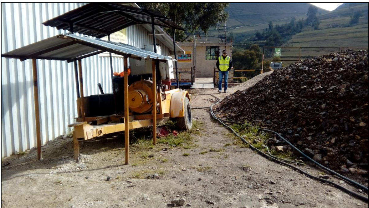
Figura 48. Generador del molino.
