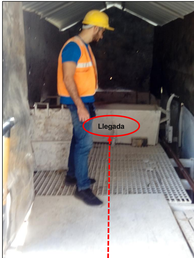
Figura 29: Punto de llegada de la Faja trasportadora. Fuente: Elaboración propia, (2018).
