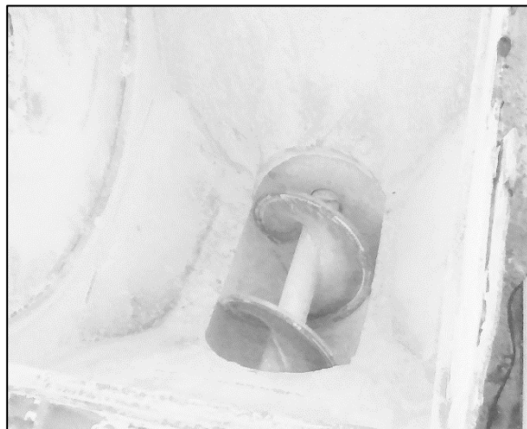
Figura 27: Boca del molino a bolas que conectará la faja transportadora con la chancadora.
