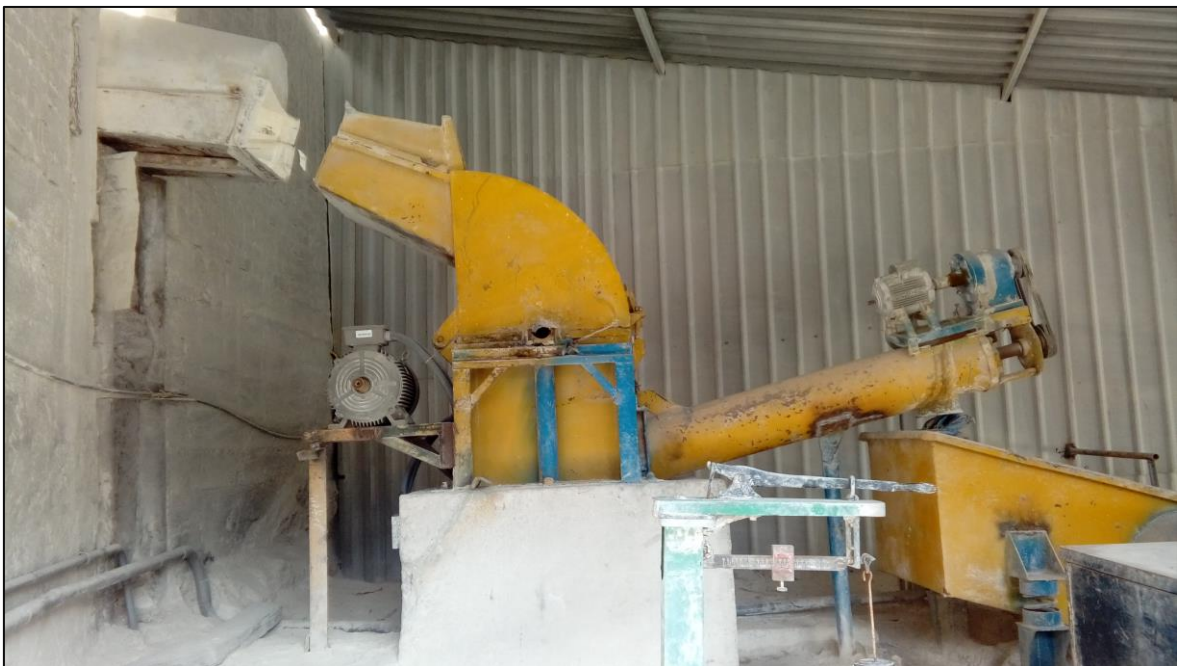
Figura 19. Zona de despacho de óxido de calcio molido. Fuente: Elaboración propia, (2017).
