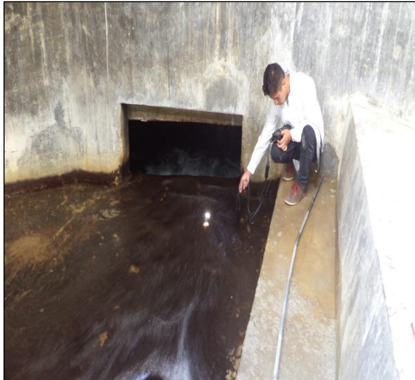
Figura 03: Captación del manantial “Tres Chorros” destinada para el distrito de Bambamarca.
