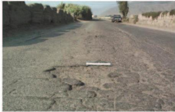
Figura n.º 20. Falla tipo huecos.
