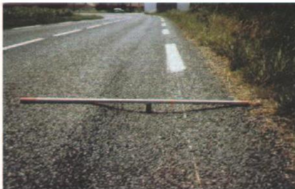
Figura n.º 12. Falla tipo depresión.
