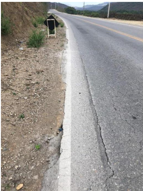
Foto nº 10: Grieta de borde
