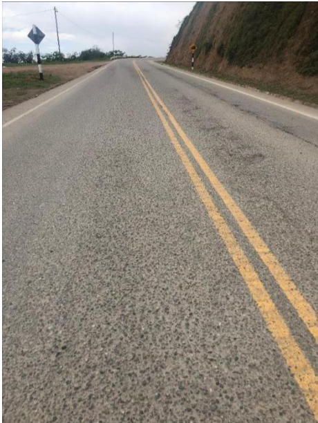
Foto nº 9: Desprendimiento de agregados
