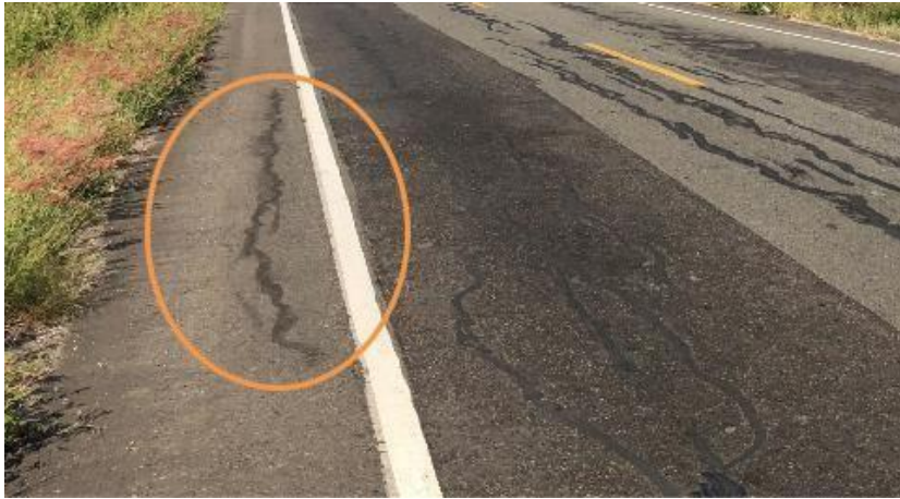
Figura n.º 36. Falla: grieta de borde.
