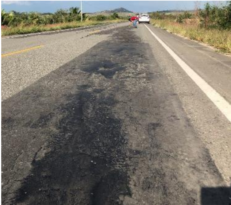
Figura n.º 33. Falla: parche de severidad H.
