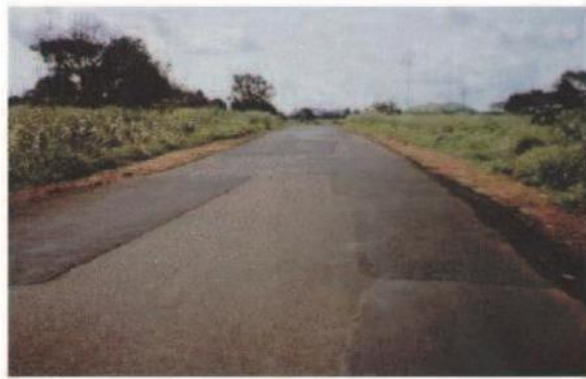
Figura n.º 18. Falla tipo parches.
