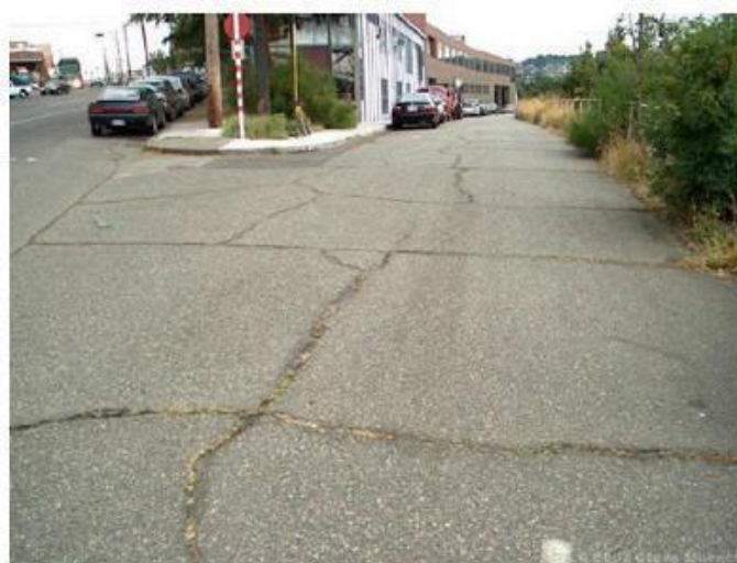
Figura n.º 14. Falla tipo grieta de reflexión de junta.
