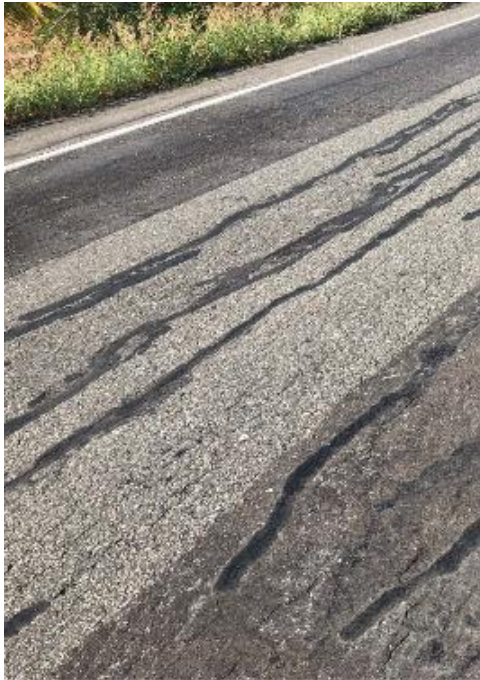
Figura n.º 38. Falla: grietas longitudinales.
