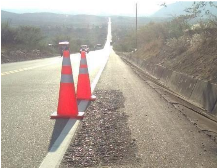
Foto nº 8: Desnivel Carril – Berma
