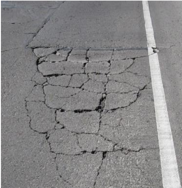
Foto n° 1: Agrietamiento en Bloque.
