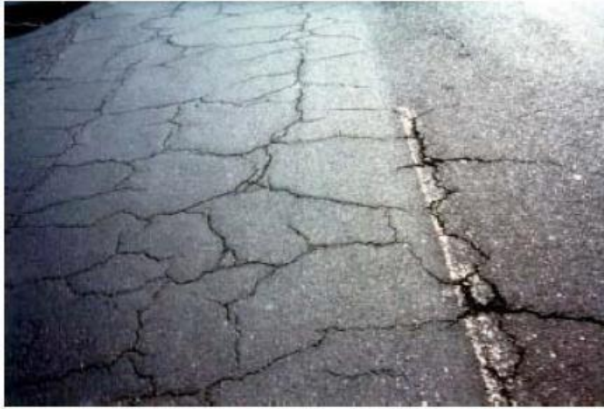
Figura n.º 8. Falla tipo agrietamiento en bloque.
