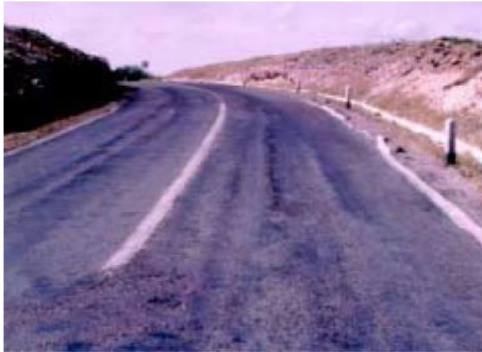
Figura n.º 25. Falla tipo hinchamiento.
