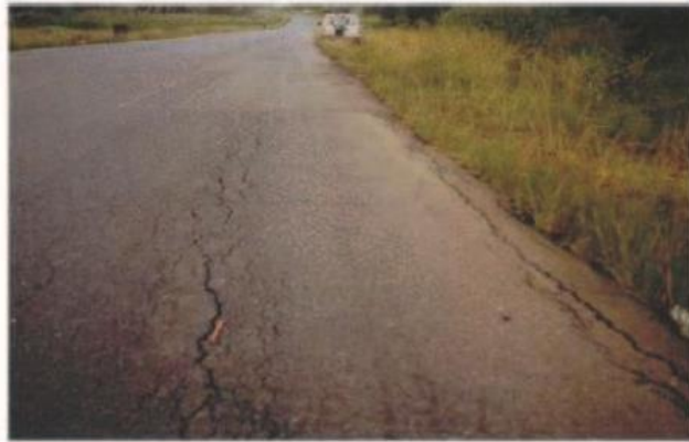
Figura n.º 16. Falla tipo grieta longitudinal.
