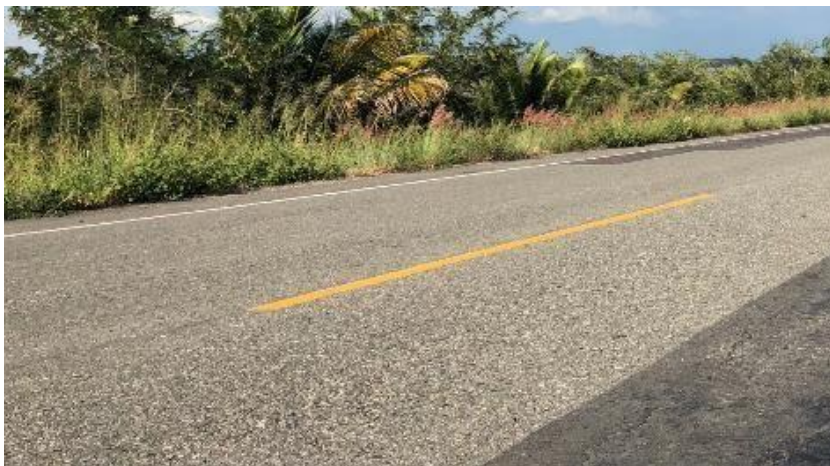
Figura n.º 34. Falla: pulimento de agregados.
