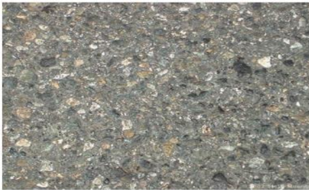
Figura n.º 19. Falla tipo pulimento de agregados.
