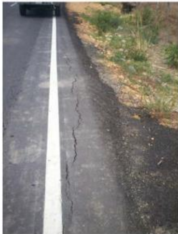
Figura n.º 13. Falla tipo grieta de borde.
