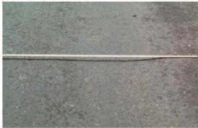
Figura n.º 10. Falla tipo hundimiento.
