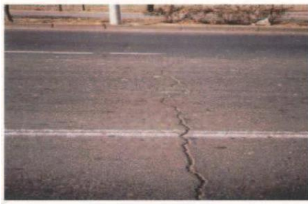
Figura n.º 17. Falla tipo grieta transversal.
