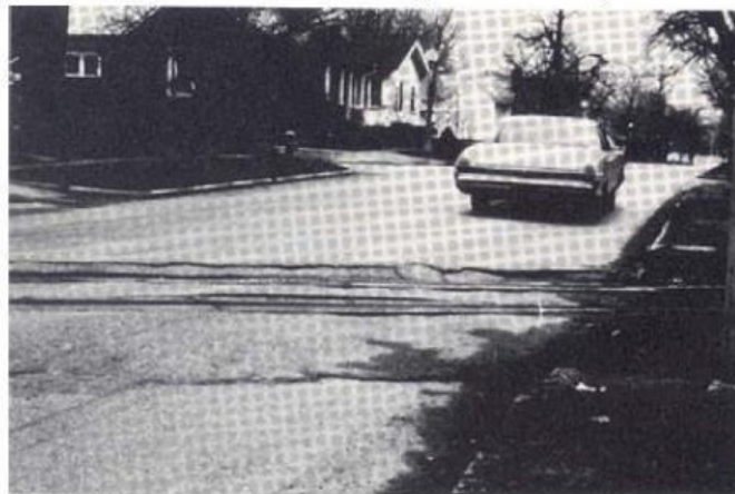
Figura n.º 21. Falla tipo cruce de vía férrea.
