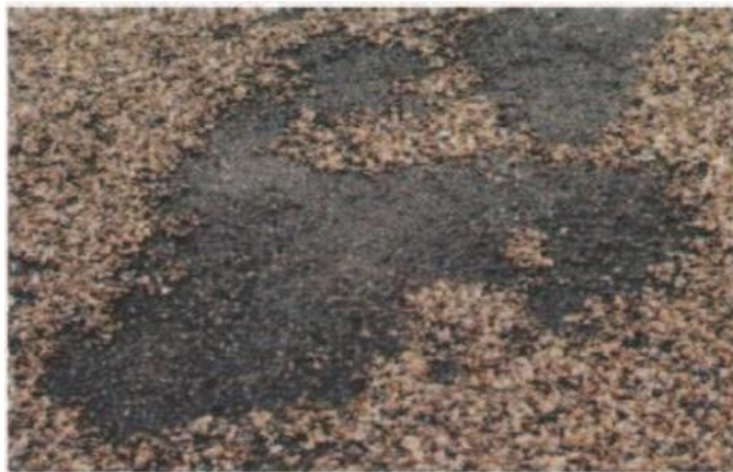
Figura n.º 26. Falla tipo desprendimiento de agregados.
