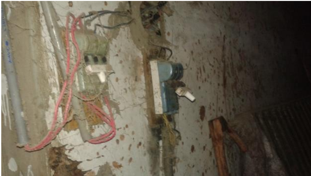
Figura 52: Instalaciones de la areas en mal estado
