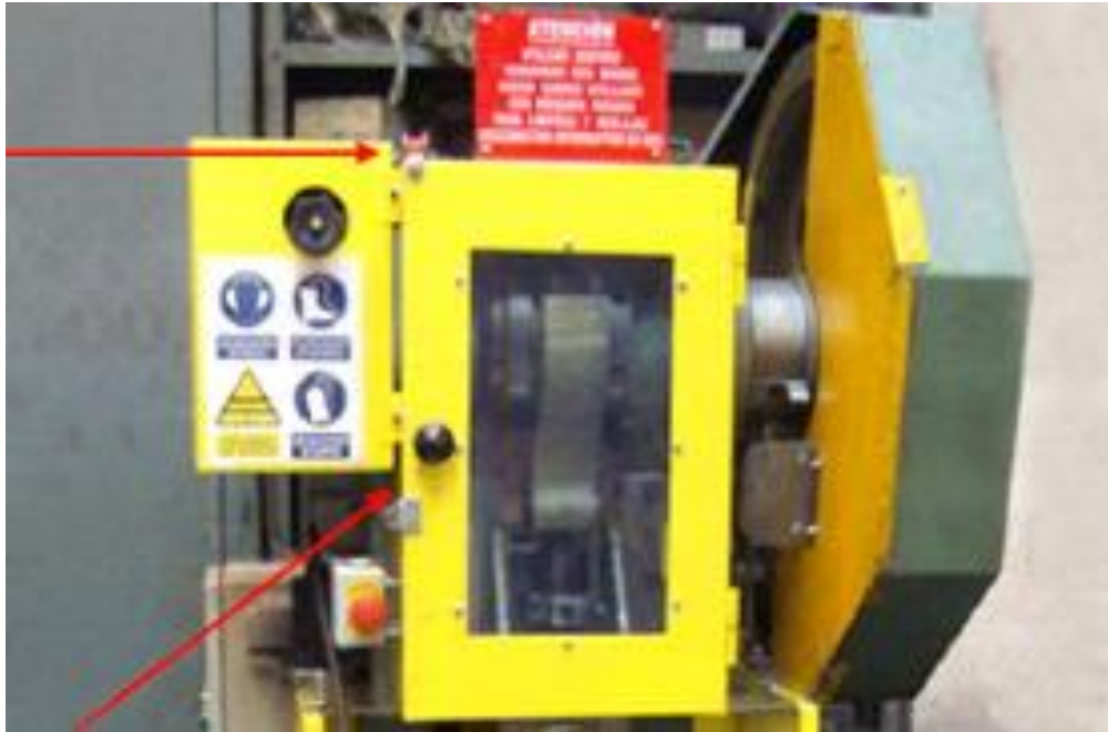
Figura 57: Ejemplo de Guarda Móvil para los Equipos del Proceso de Curtido y Recurtido de Pieles de la Empresa Representaciones y Curtiembre San José E.I.R.L. Cajamarca.
