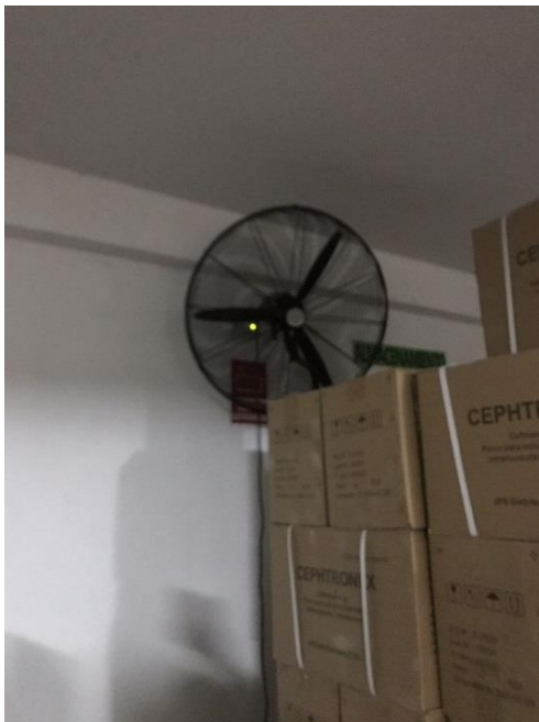
Figura 13: Ventiladores de Almacén
