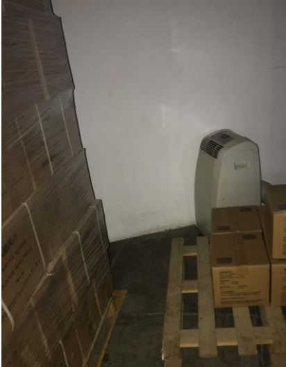
Figura 22. Equipos mal ubicados
