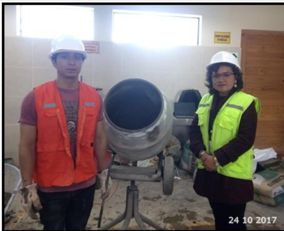
Foto 26: Con la ingeniera Anita Alva supervisando el desarrollo de la mezcla de concreto.
