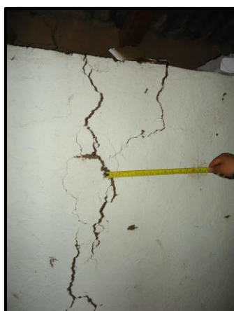
Figura N° 28 Desgarramiento de Muro
