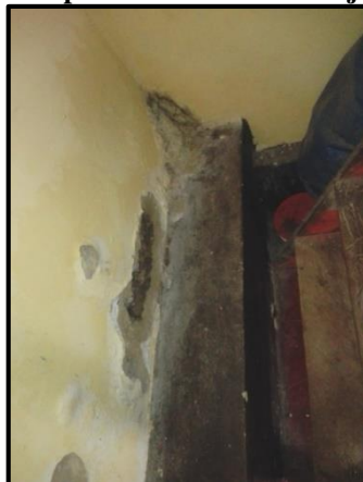
Figura N° 26 Desprendimiento de Tarrajeo
