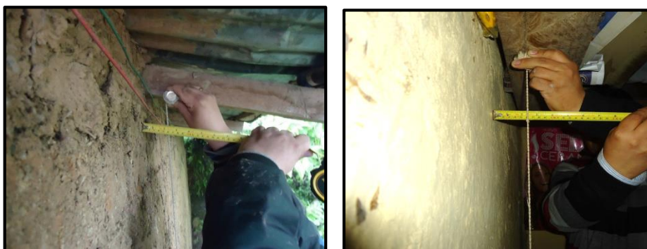
Figura N° 27 Desplome de muros
