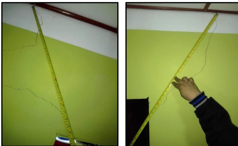
Figura N° 24 Fisuras en muros
