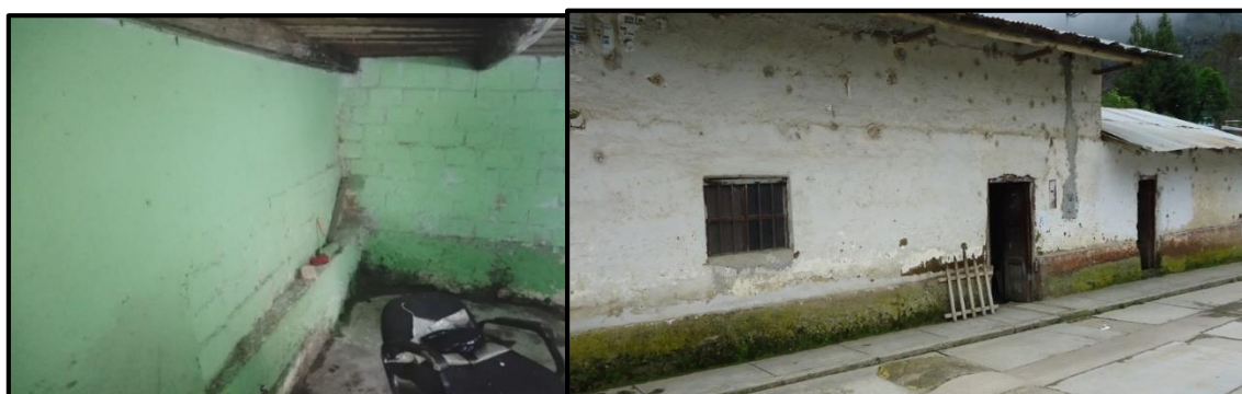
Figura N° 25 Humedad en muros
