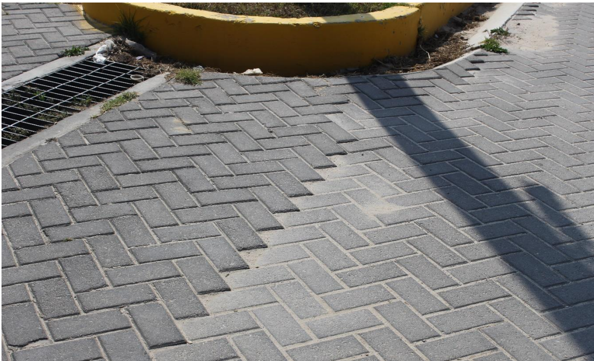
Figura 31. Falla de abultamiento en la Av. Pachacútec (Tramo Km01 + 174 – Km01 + 224)
