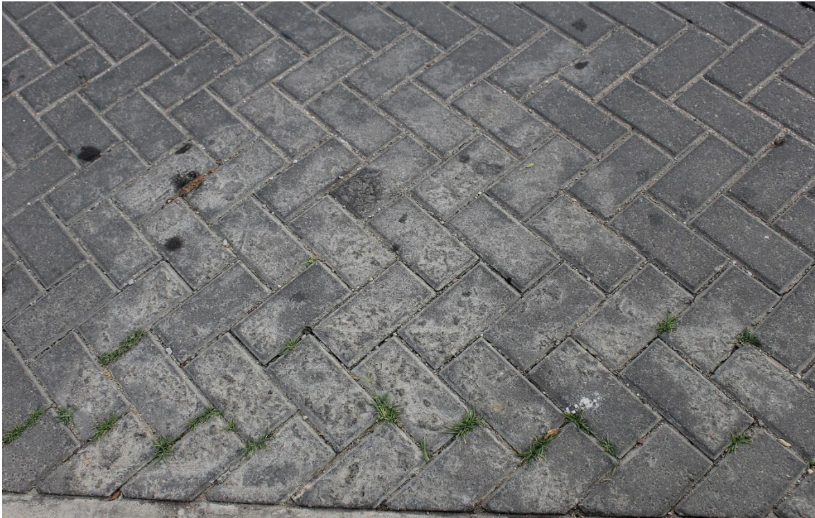
Figura 16. Falla de desgaste superficial en la Av. Huáscar (Tramo Km00 + 050 – Km00 + 100)
