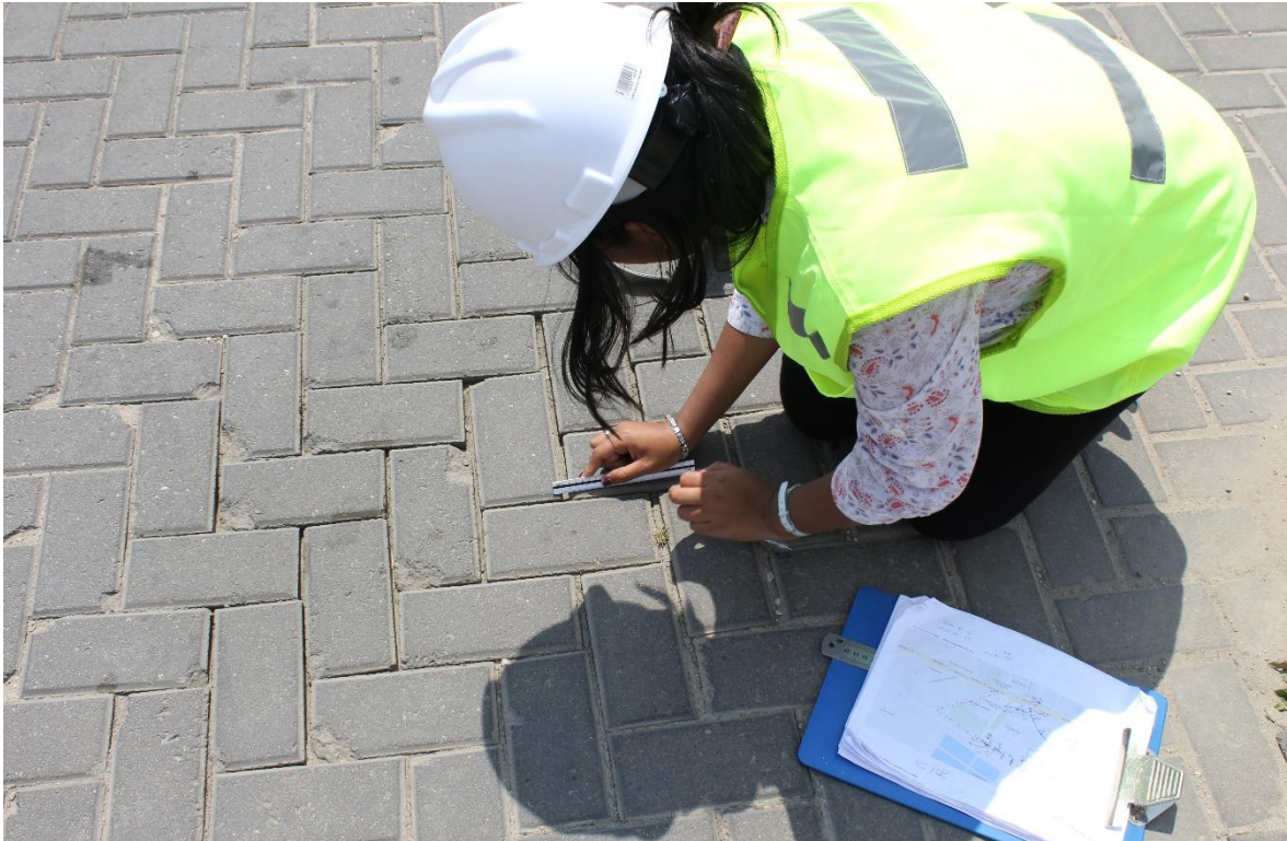
Figura 38. Medición de la falla de juntas abiertas en la Av. Pachacútec (Tramo Km00 + 924 – Km00 + 974)
