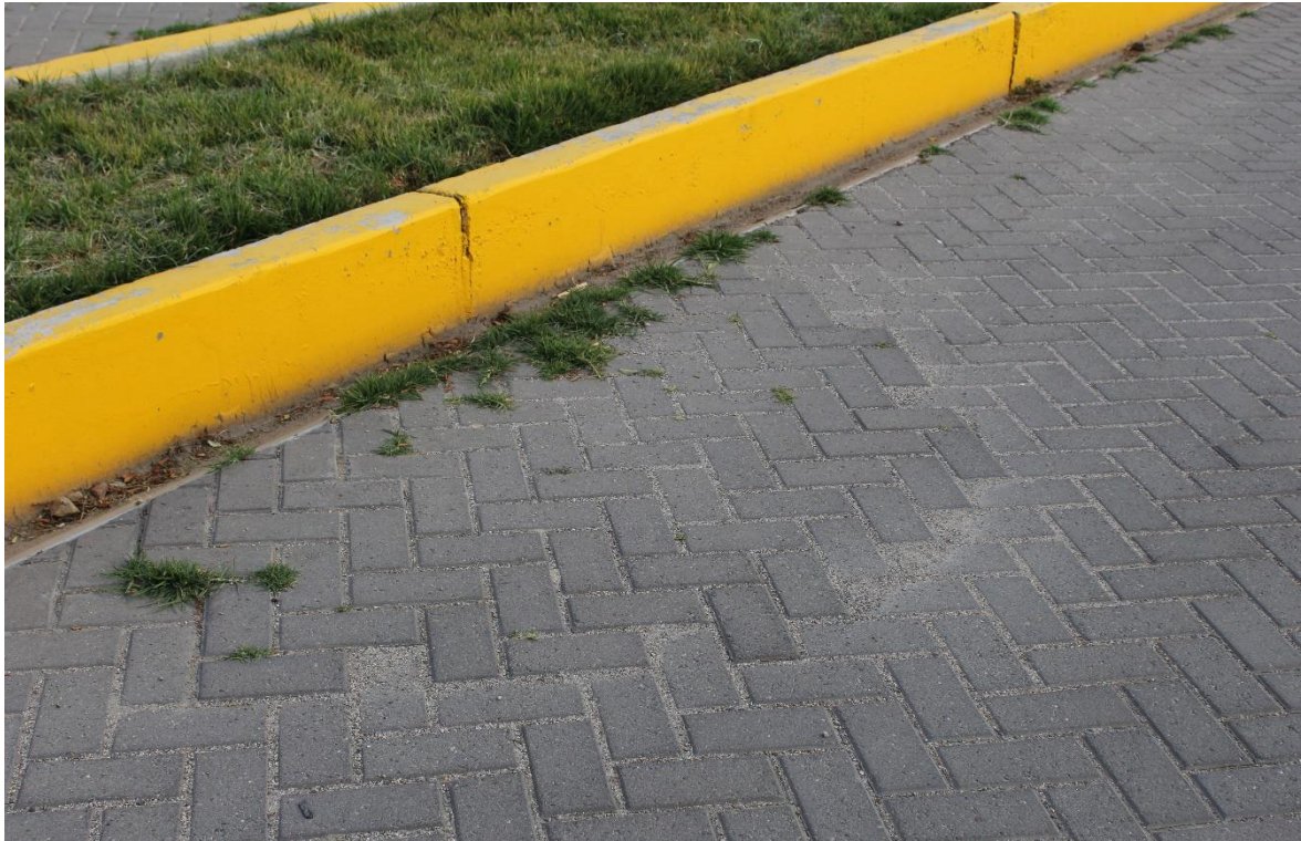
Figura 24. Falla de abultamiento en la Av. Manco Cápac (Tramo Km00 + 350 – Km00 + 400)
