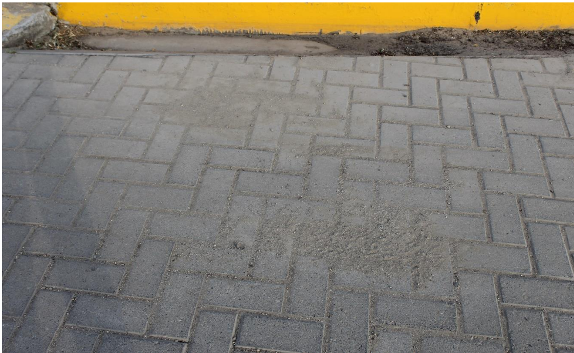
Figura 25. Falla de pérdida de arena en la Av. Manco Cápac (Tramo Km00 + 400 – Km00 + 450)
