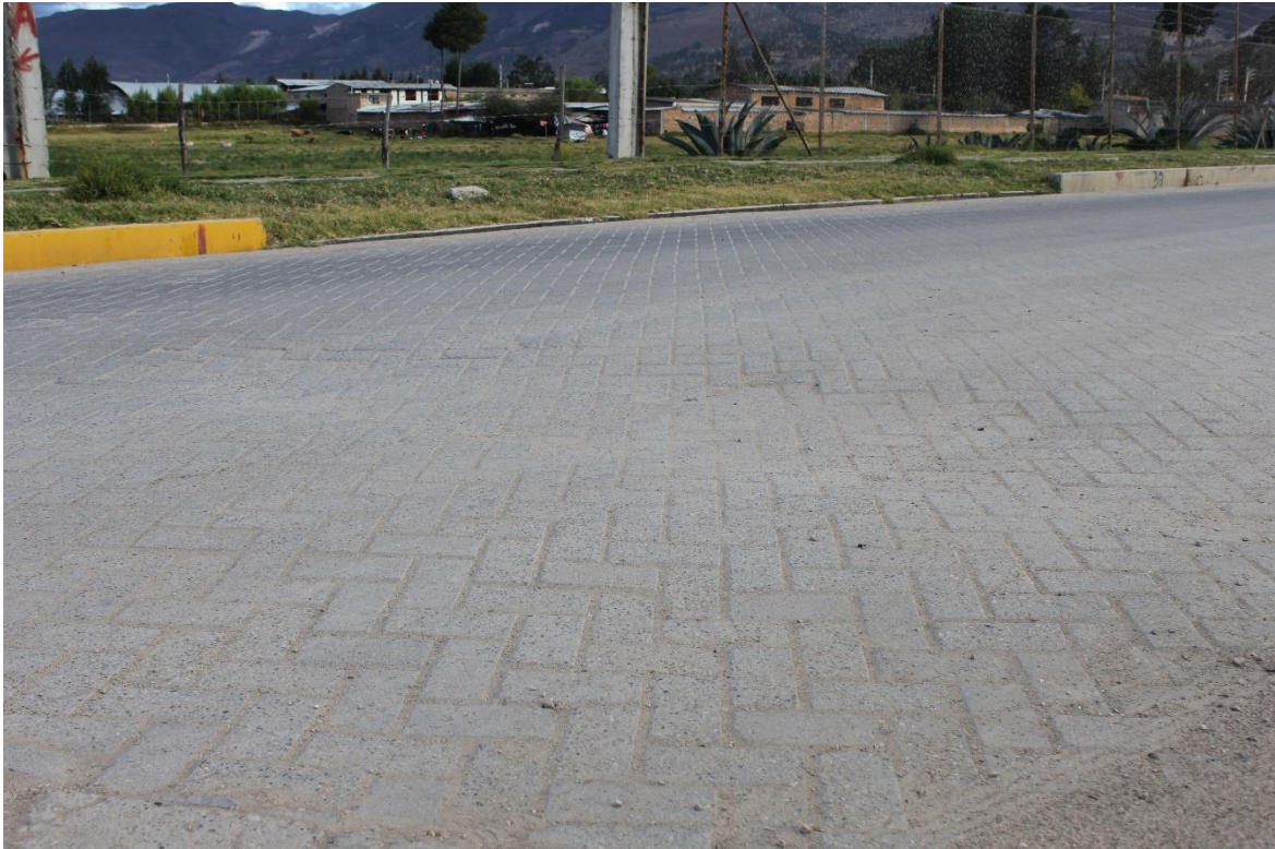
Figura 40. Falla de depresiones en la Av. Wiracocha (Tramo Km01 + 274 – Km01 + 324)
