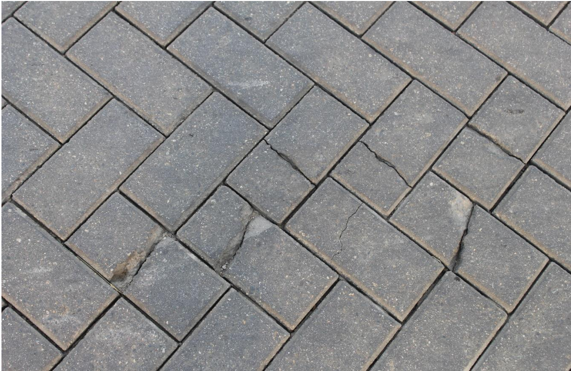
Figura 18. Falla de fracturamiento en la Av. Huáscar (Tramo Km00 + 150 – Km00 + 200)
