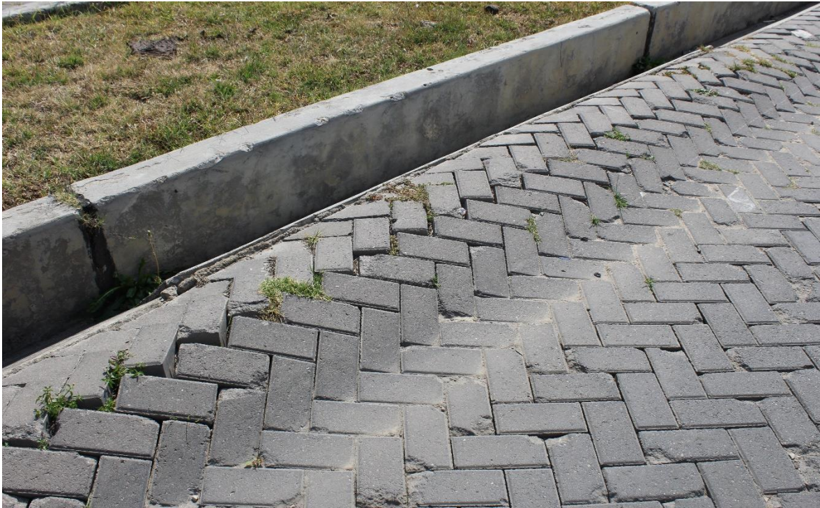
Figura 32. Falla de ahuellamiento en la Av. Pachacútec (Tramo Km01 + 124 – Km01 + 174)
