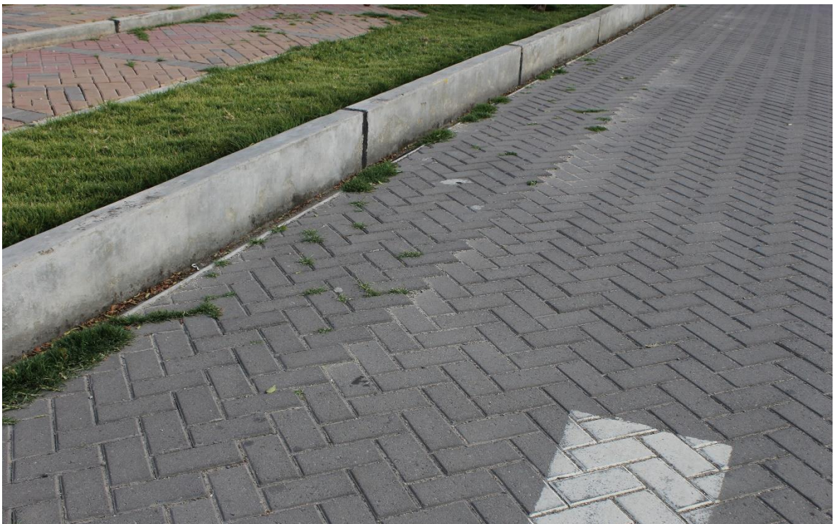
Figura 23. Falla de abultamiento en la Av. Manco Cápac (Tramo Km00 + 550 – Km00 + 586)
