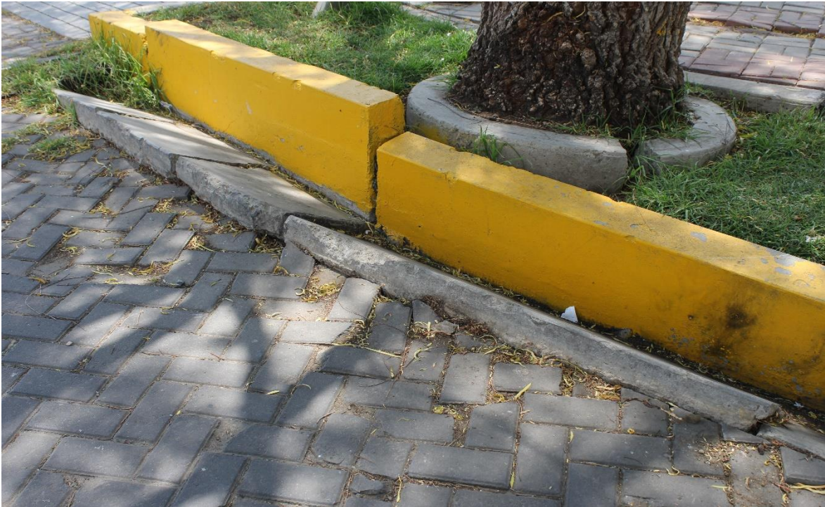
Figura 26. Falla de desplazamiento de bordes y fracturamiento de confinamiento externo en la Av. Manco Cápac (Tramo Km00 + 350 – Km00 + 400)
