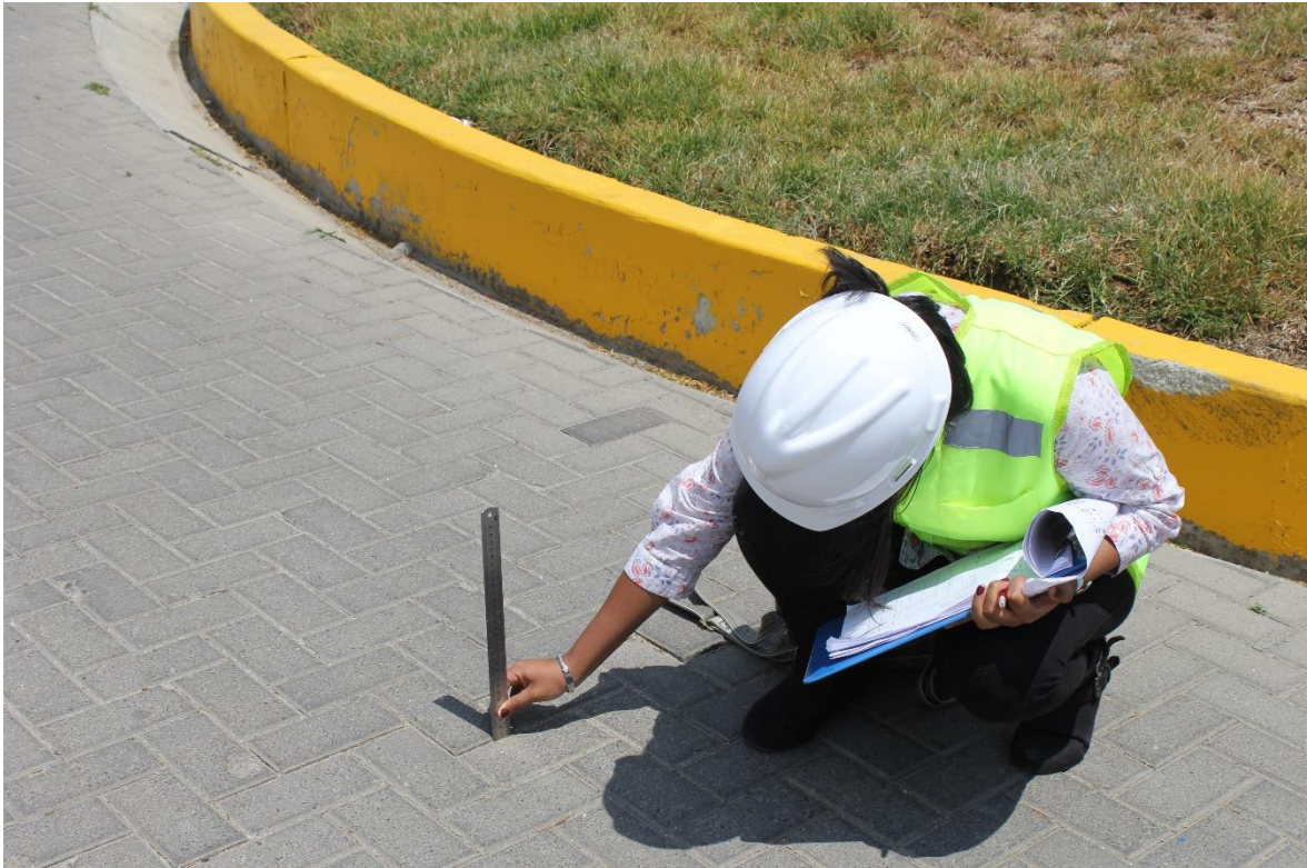
Figura 30. Medición de la falla de abultamiento de la Av. Manco Cápac (Tramo Km00 + 400 – Km00 + 450)
