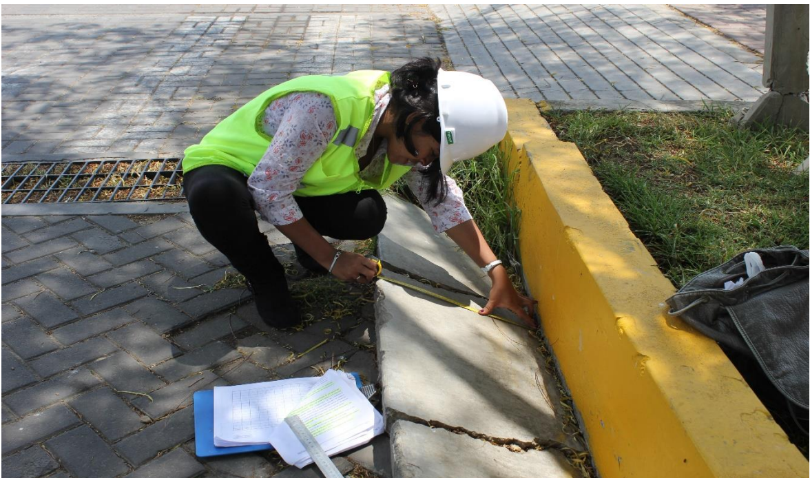
Figura 29. Medición de la falla de fracturamiento de confinamiento externo en la Av. Manco Cápac (Tramo Km00 + 500 – Km00 + 550)
