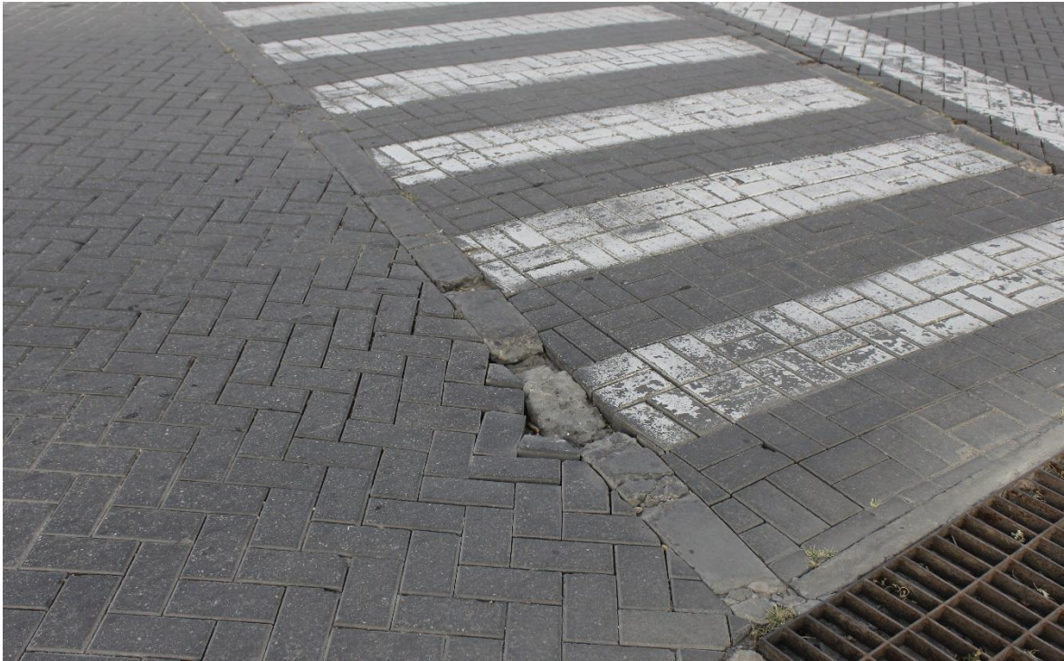
Figura 34. Falla de fracturamiento de confinamiento interno en la Av. Pachacútec (Tramo Km01 + 074 – Km01 + 124)
