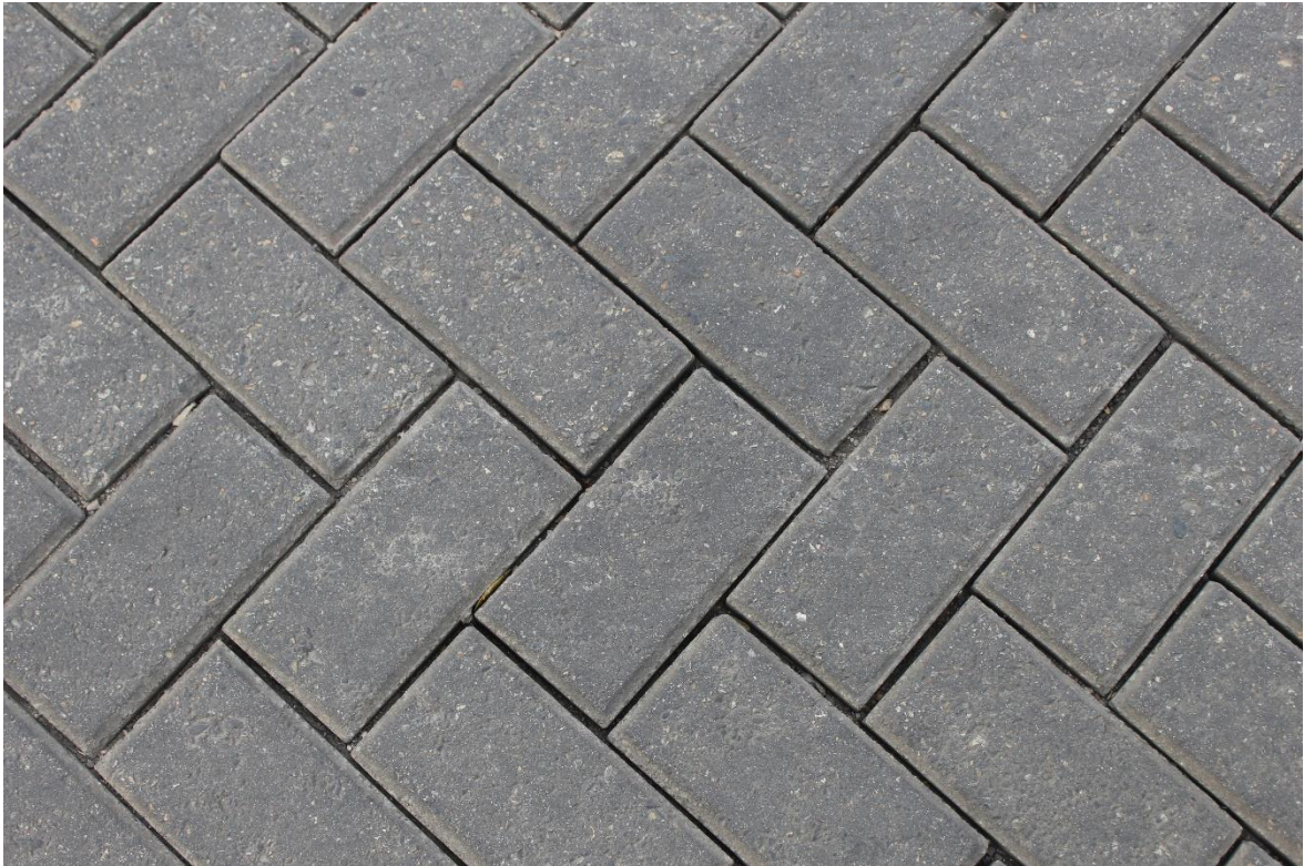
Figura 20. Falla de juntas abiertas en la Av. Huáscar (Tramo Km00 + 150 – Km00 + 200)
