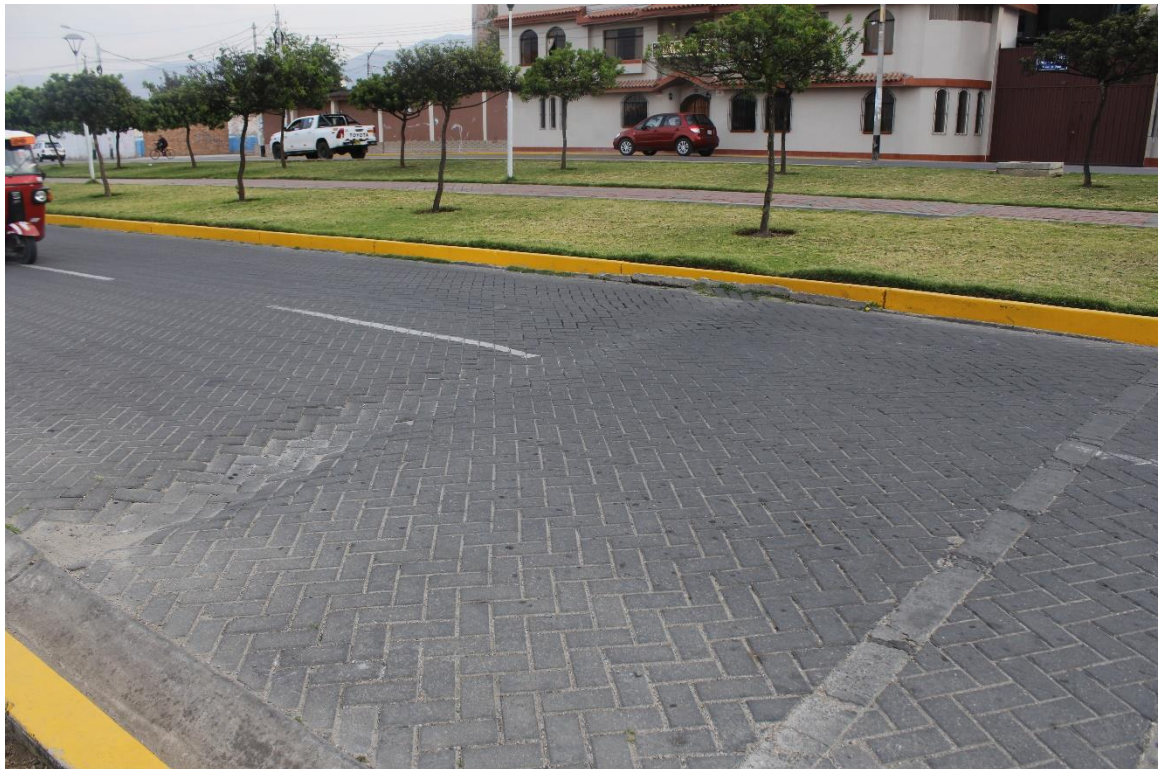
Figura 17. Falla de depresión en la Av. Huáscar (Tramo Km00 + 200 – Km00 + 250)
