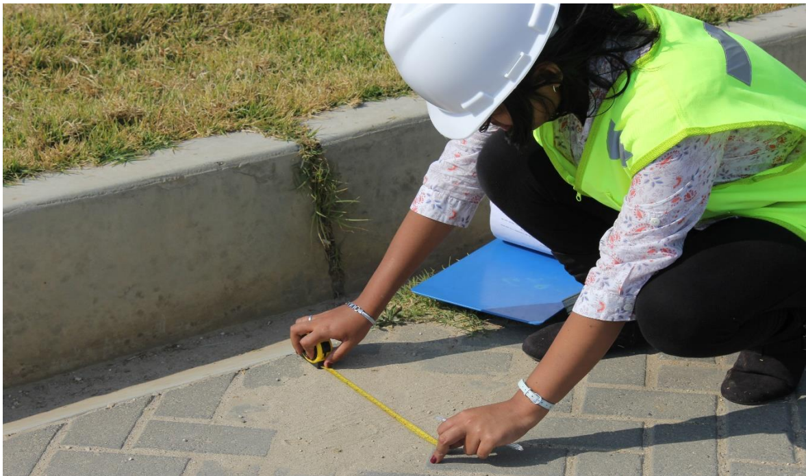
Figura 39. Medición del área de la falla de pérdida de arena la Av. Pachacútec (Tramo Km00 + 736 – Km00 + 786)
