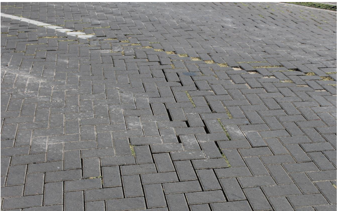
Figura 35. Falla de juntas abiertas en la Av. Pachacútec (Tramo Km01 + 124 – Km01 + 174)
