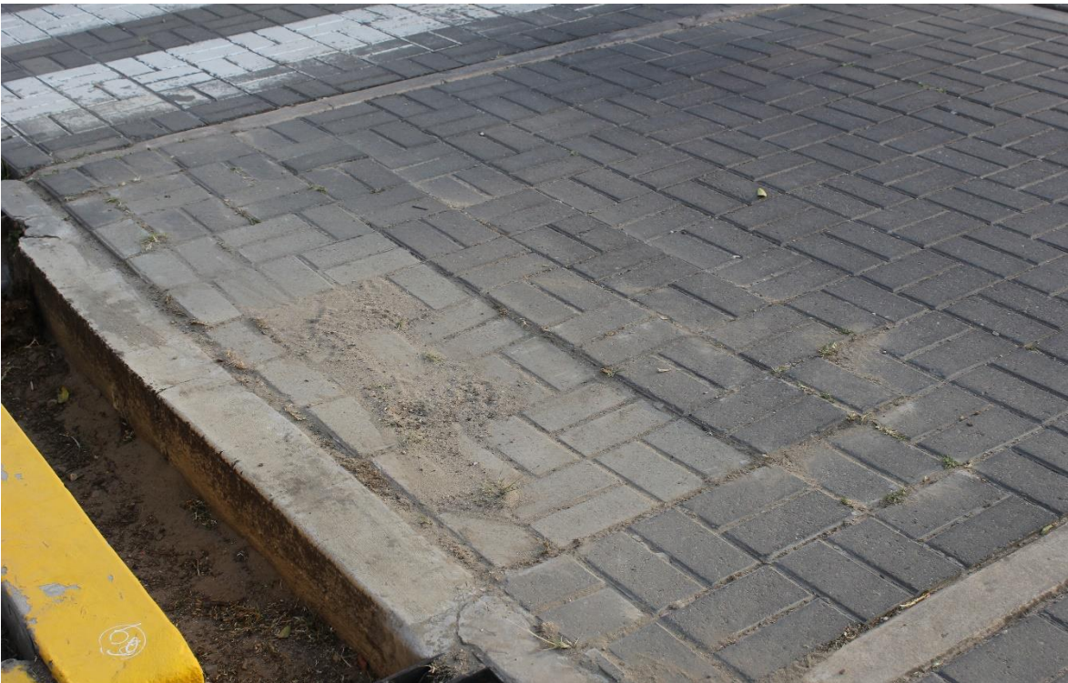
Figura 27. Falla de depresión en la Av. Manco Cápac (Tramo Km00 + 350 – Km00 + 400)
