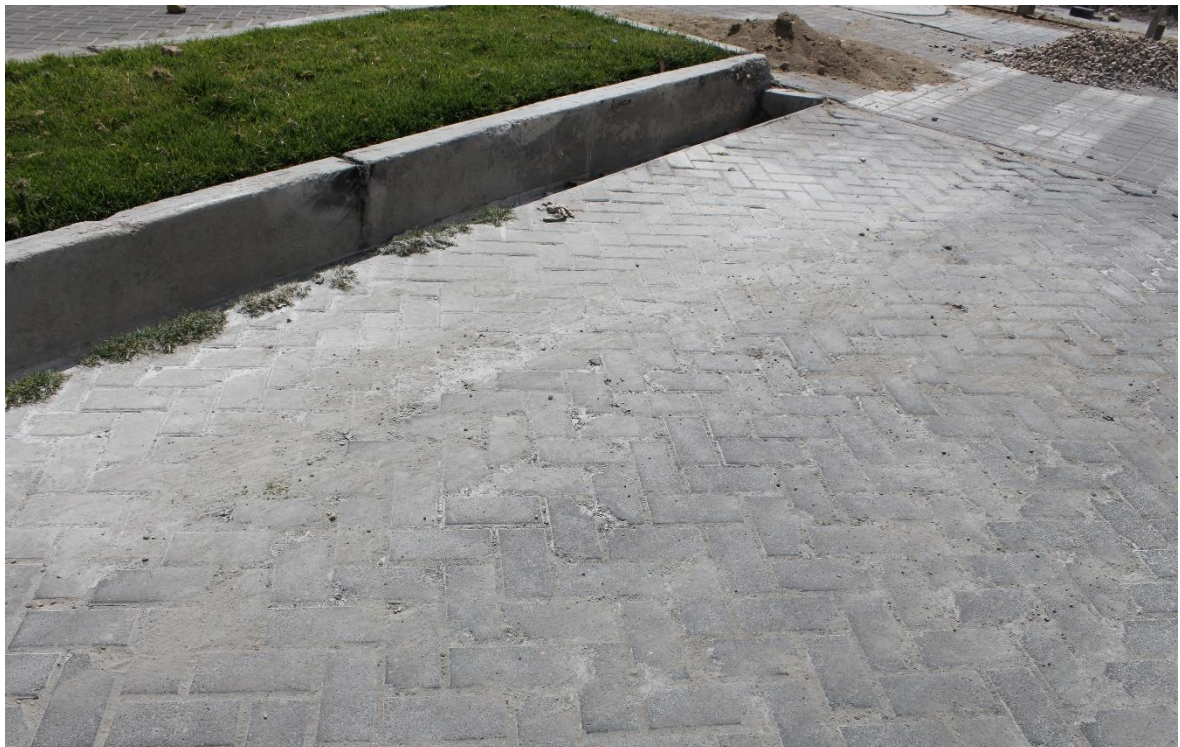
Figura 33. Falla de desgaste superficial en la Av. Pachacútec (Tramo Km01 + 174 – Km01 + 224)
