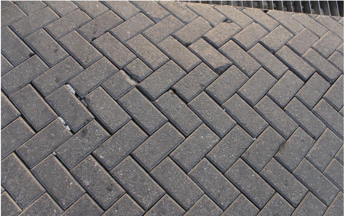
Figura 22. Falla de juntas abiertas con fracturamiento en la Av. Huáscar (Tramo Km00 + 150 – Km00 + 200)
