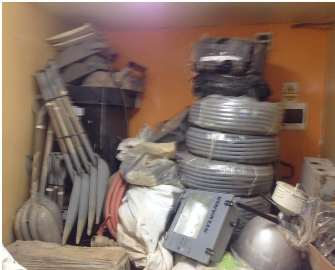
Figura n° 15. Punto crítico N° 4 – Desorden
