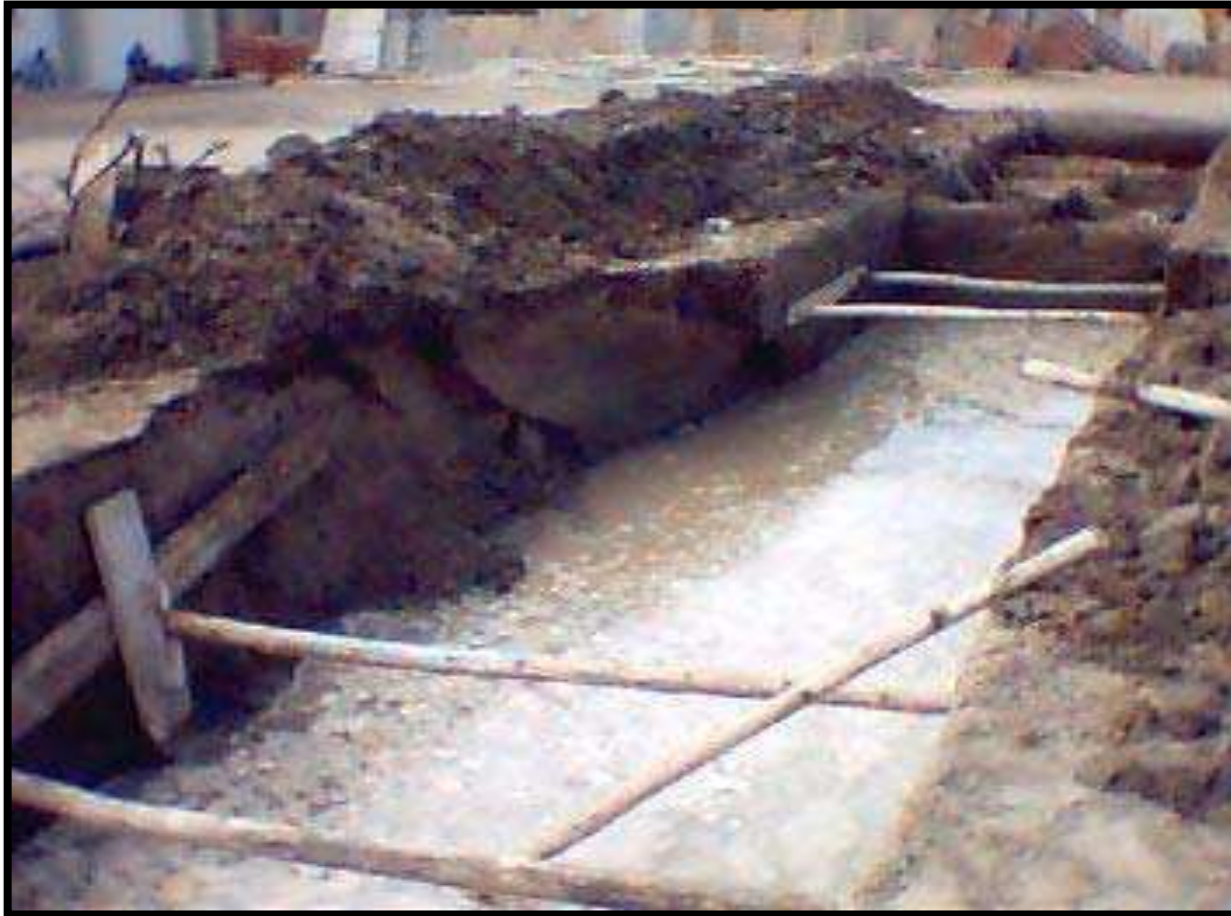
Figura N° 01: Desmoronamiento de talud en suelo arenoso con baja cohesión. Fuente: Influencia de las propiedades del suelo en el diseño de cimentaciones - Rodríguez S. William
