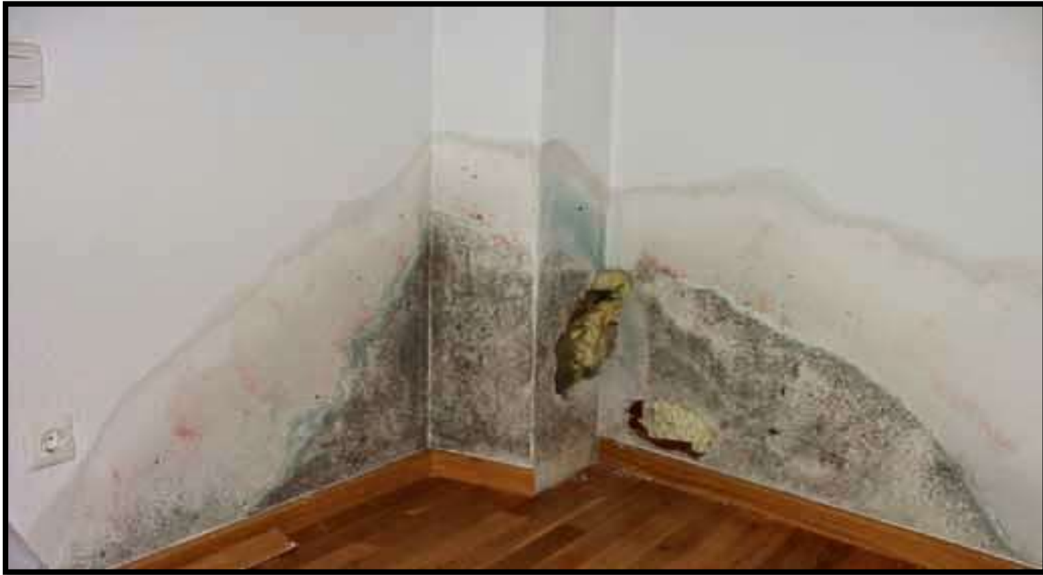
Figura N° 05: Vivienda afectada por el alto nivel freático.
