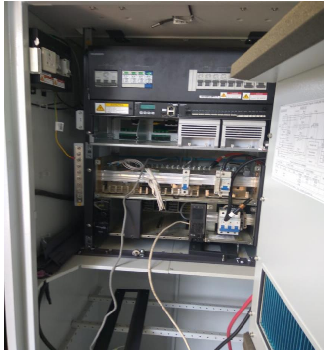
Figura n.º 21. Observación de elementos internos de un sistema fotovoltaico por parte de los autores
