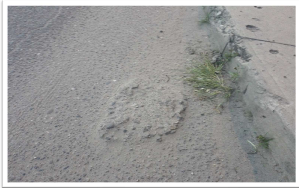
Fotografía N° 23: Abultamiento en Unidad 3
