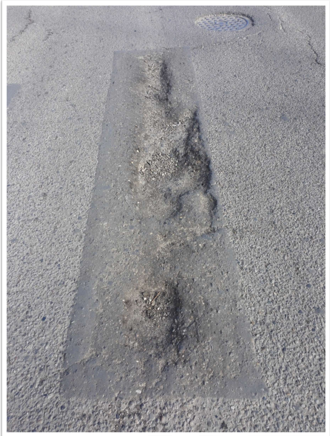
Fotografía N° 27: Parches y Huecos de la Unidad 12
