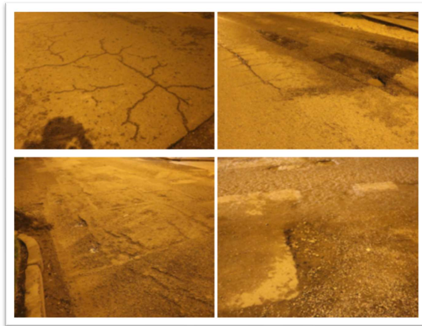
Fotografía N° 10: Fallas Av. Mario Urteaga
