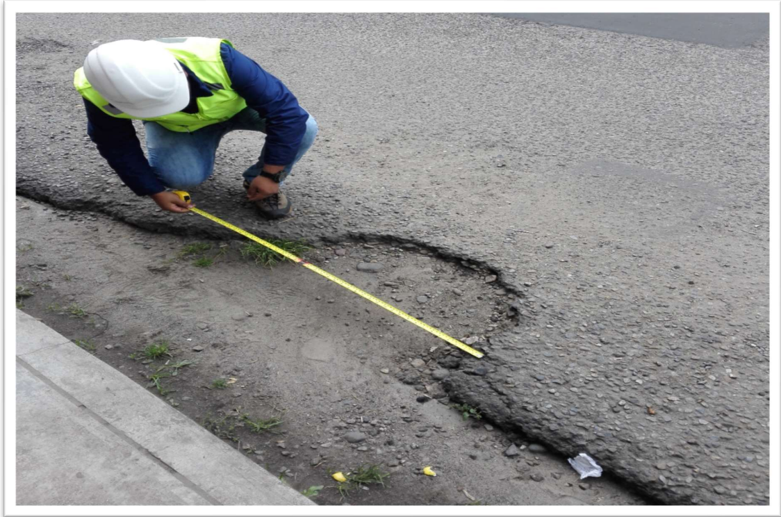
Fotografía N° 32: Grieta de Borde Unidad 10
