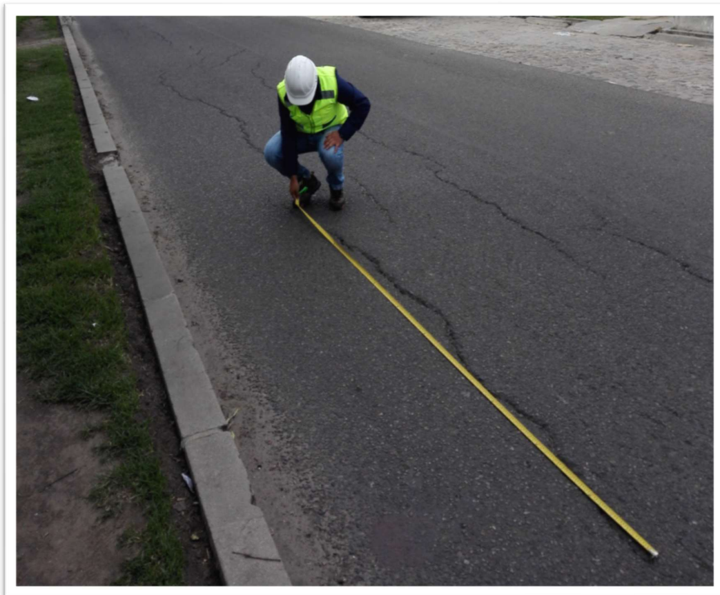
Fotografía N° 24: Medición de grietas longitudinales Unidad 15
