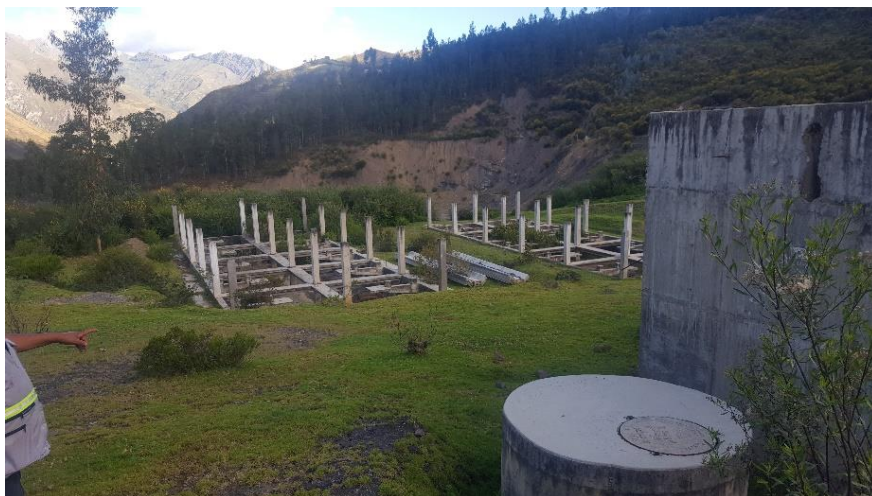
Foto 3: Lecho de secado - estructuras en abandono
