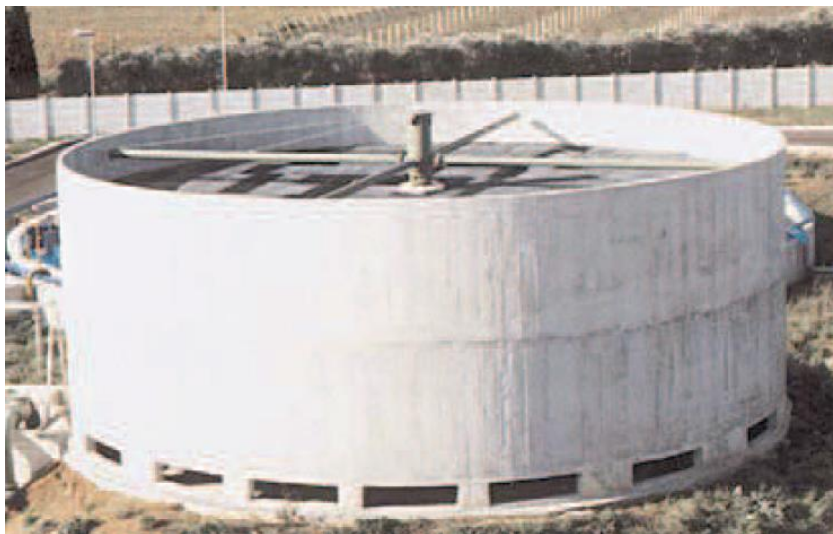
Imagen 21: Vista de filtro percolador
