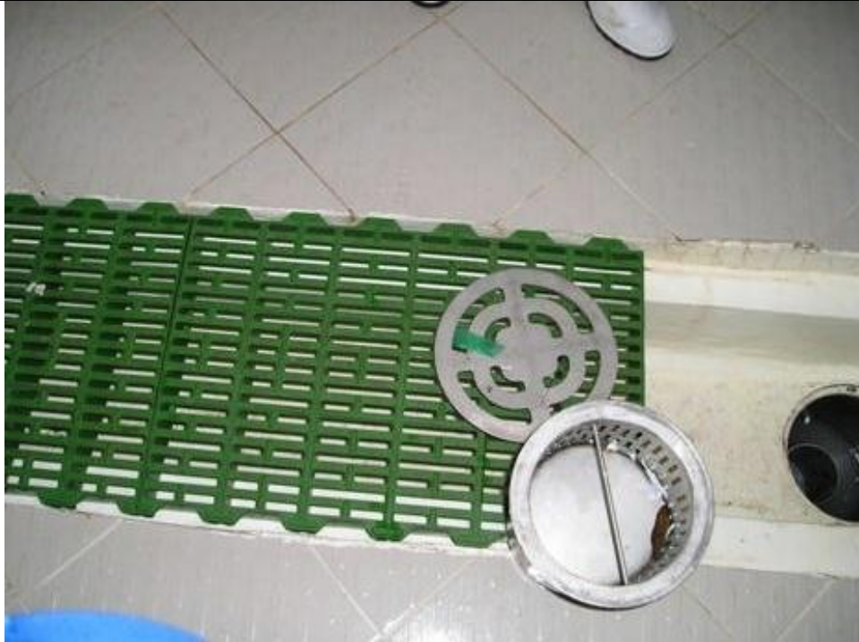
Figura 1. Rejillas y trampas de grasa para retención de sólidos
