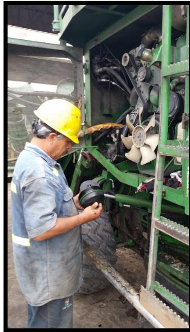
Figura 48: Cambio filtro de aceite de motor. Fuente: División Mantenimiento
