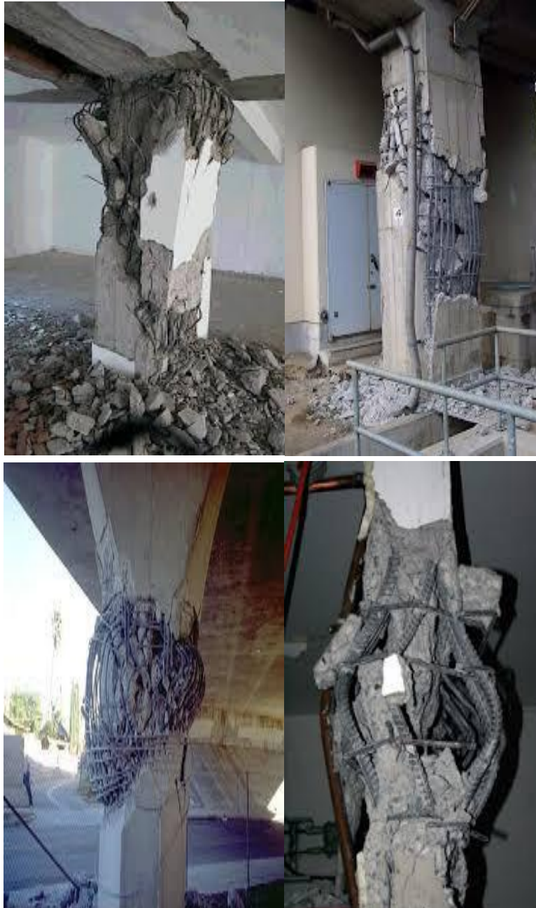
Foto 5 : Columnas con fallas por aplastamiento, Fuente: Google.com
