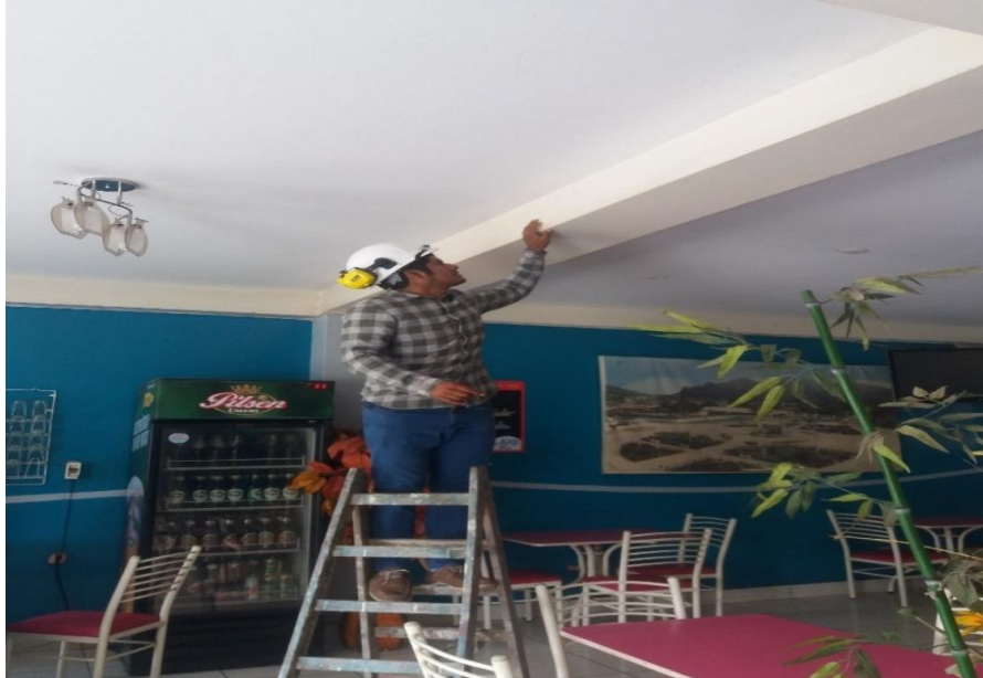
Foto 10: revisión de la viga grietas, Fuente: Propia
