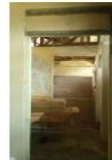
Falta limpieza y pintado de ambientes.
