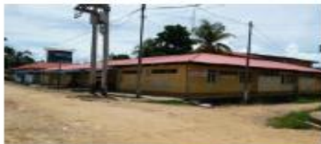
Falta limpieza y pintado de toda la infraestructura.
