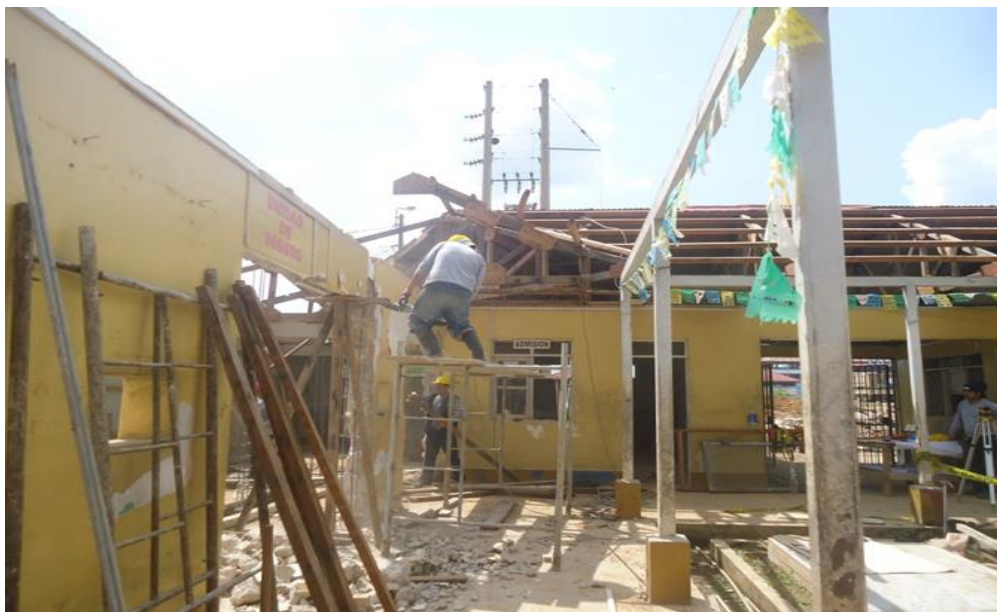
Figura 8. Demolición de columnas (muestra poca resistencia al uso de equipos) Fuente: Elaboración Propia
