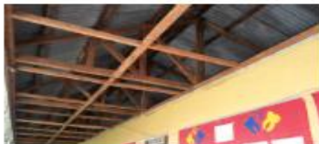
Falta colocación de cielo raso en todos los ambientes.
