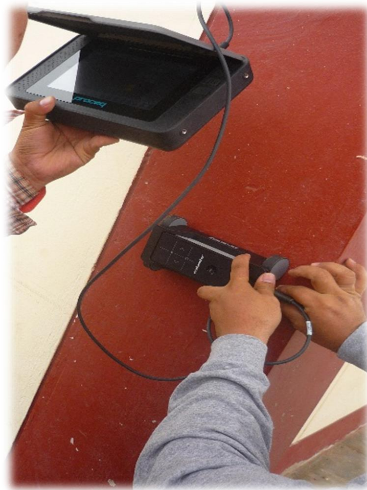
Foto 06. Escaner de las columnas de concreto armado que determinar la ubicación del acero de refuerzo y estribos
