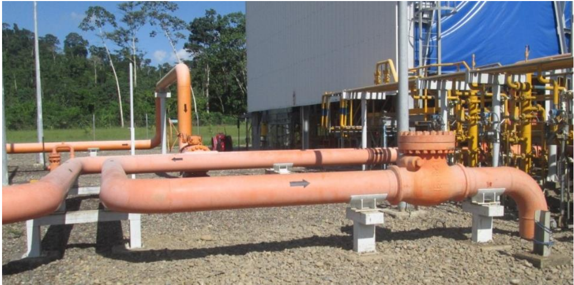
Figura N° 19. Soporte de concreto y metálico para tubería aérea
