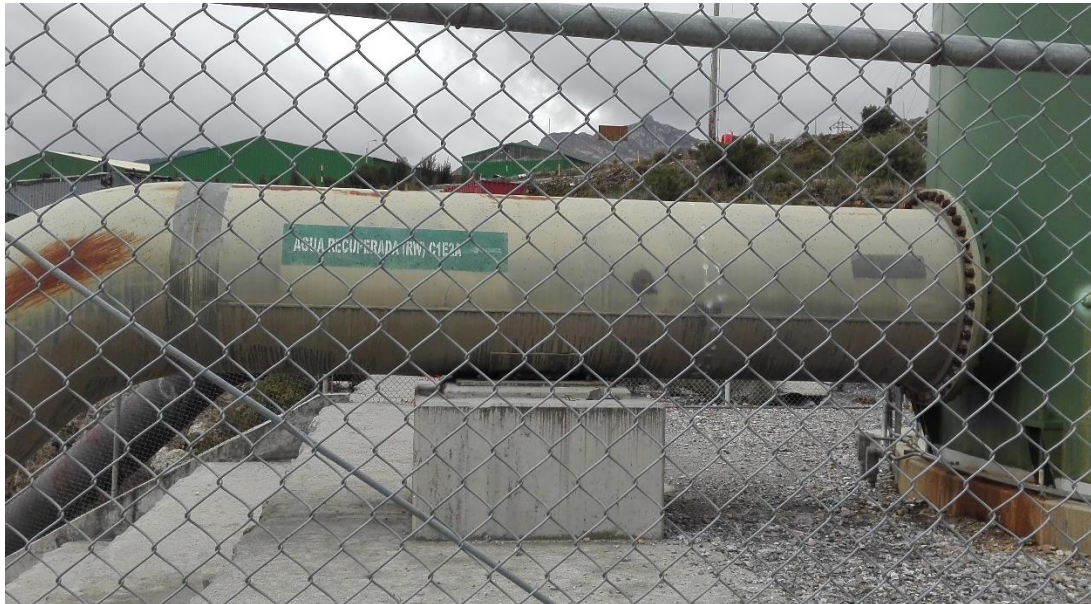
Figura N° 16. Soporte de concreto para tubería aérea
