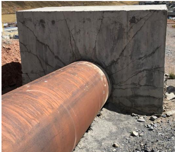
Figura N° 11. Falla de soporte de concreto en tubería de acero
