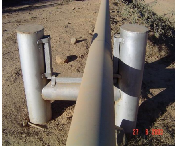
Figura N° 17. Soporte metálico para tubería aérea
