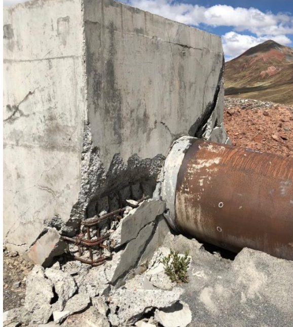
Figura N° 10. Falla de soporte en tubería en minera peruana
