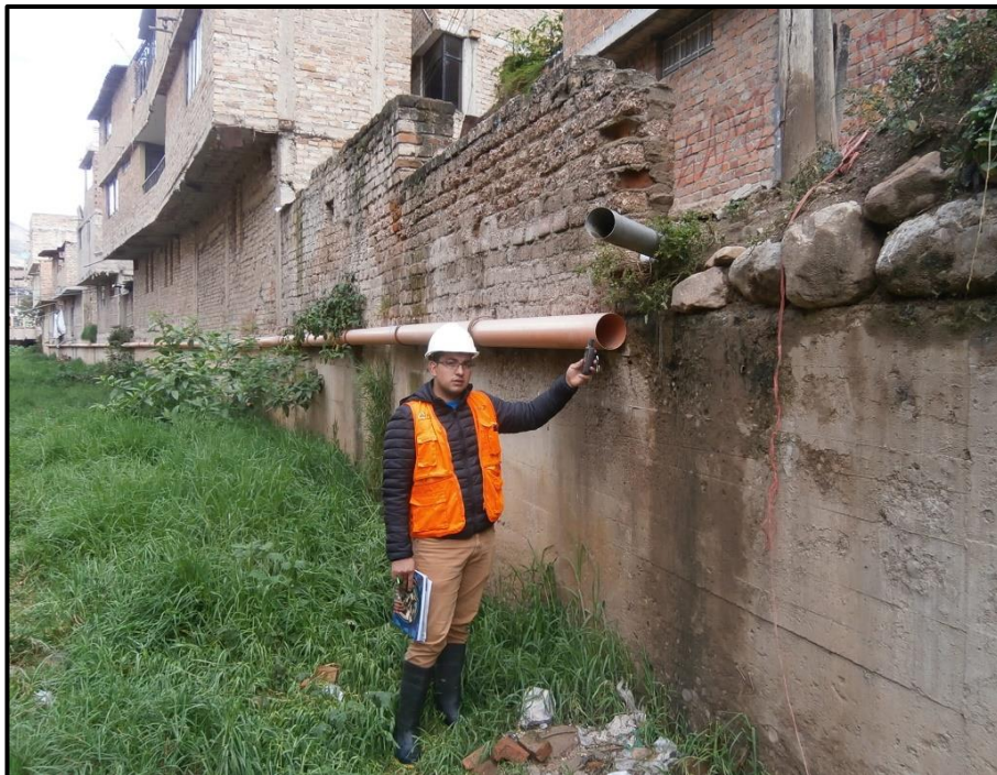
Fotografía 6 Colector de Agua residual barrio San José.
