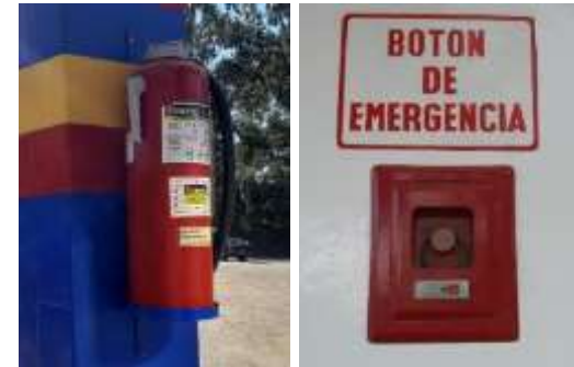
Ilustración n.º 6 Equipo contra incendios y botón de emergencia
