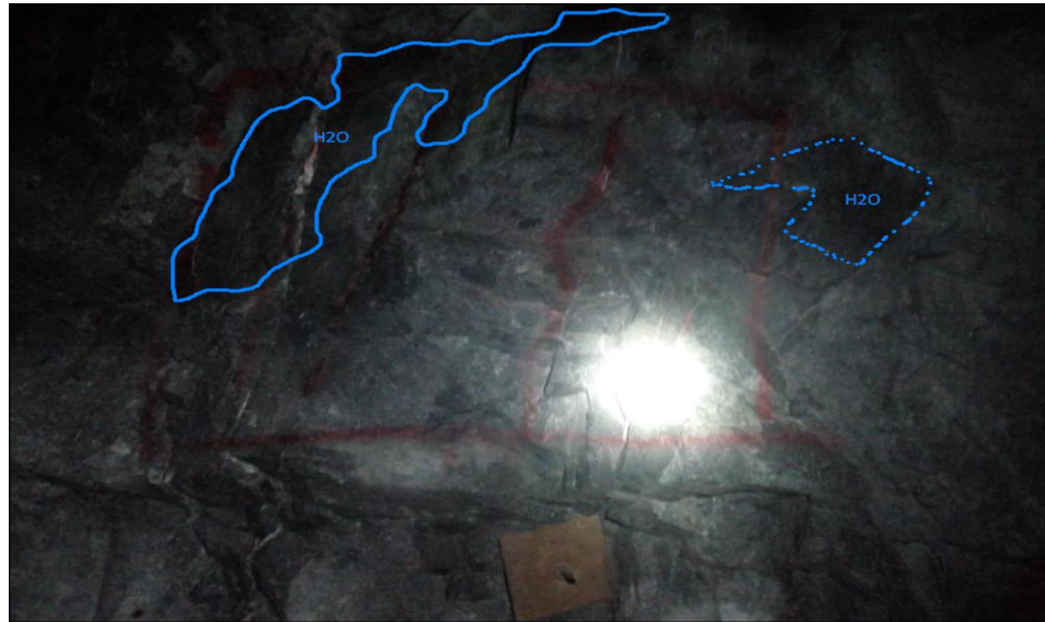
Figuras 7: Presencia de agua en la discontinuidad, mapeo geomecánico de la rampa Karent. Fuente: elaboración propia.
