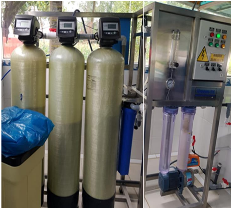
Figura 3. Sistema de filtración de la planta de tratamiento de Aguas del Inka
