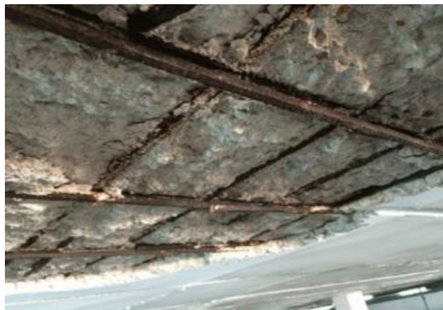
Figura 5. Acero oxidado en concreto armado.
