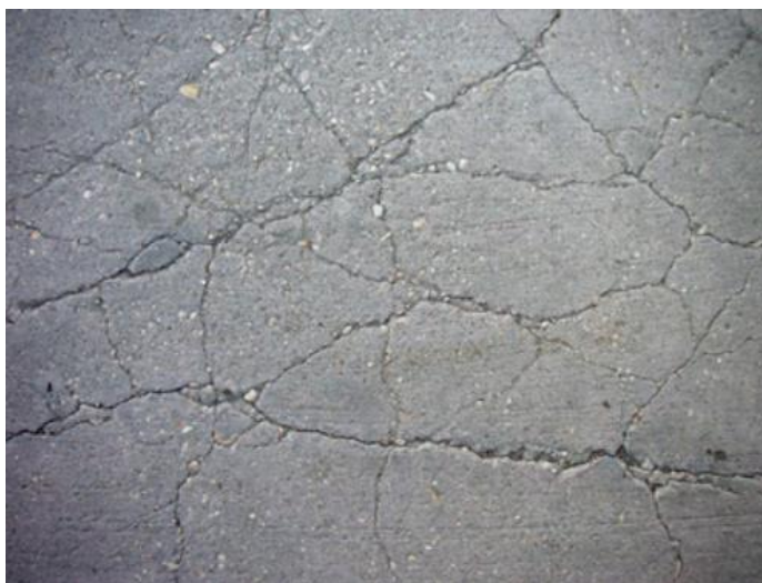
Figura 6. Fisuras al concreto armado.
