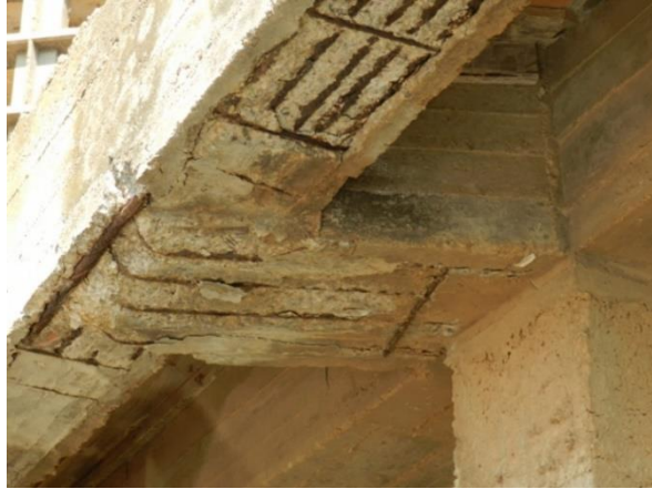
Figura 4. Vigas y losas de concreto afectadas por corrosión.
