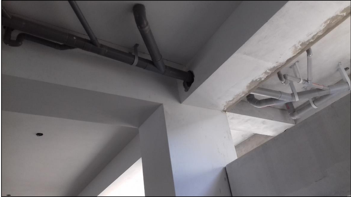
Figura 59: Interferencia entre tubería de desagüe y viga estructural.
