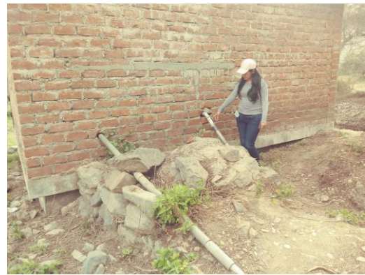
44. Captación del caserío de Cajamarca-Simbal II
