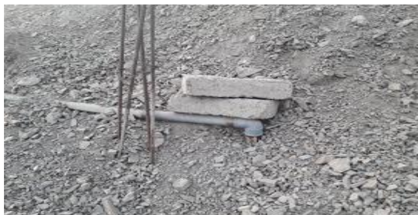
49. Línea de aducción del caserío de Cajamarca-Simbal II
