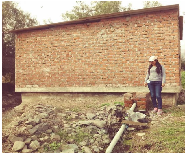
46. rebose en cámara de captación
