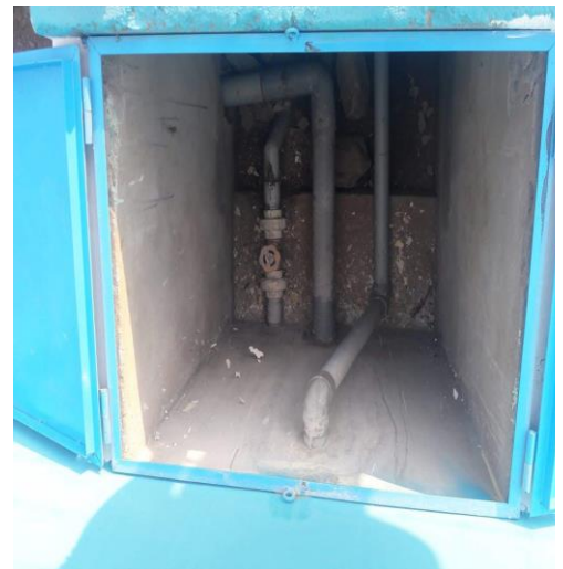
48. Línea de aducción del caserío de Cajamarca-Simbal I
