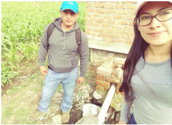
45. Captación del caserío de Cajamarca-Simbal I
