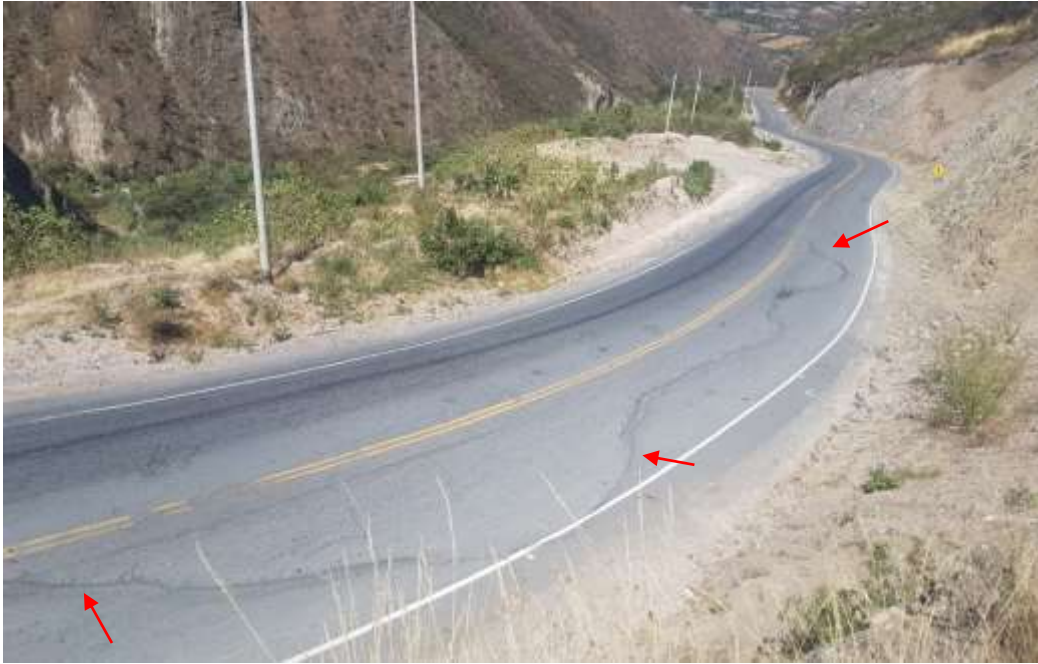
Figura 51. Hundimiento en la carretera del talud.
