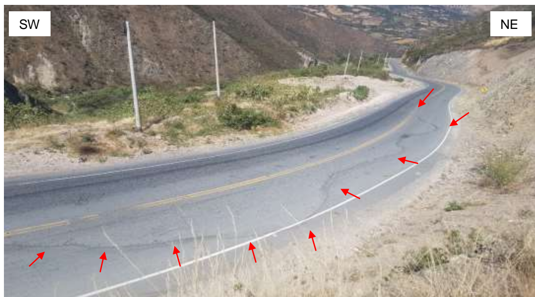
Figura 23. Hundimiento en la carretera del talud.
