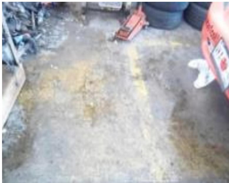
Figura 30. Piso sin señalización.
