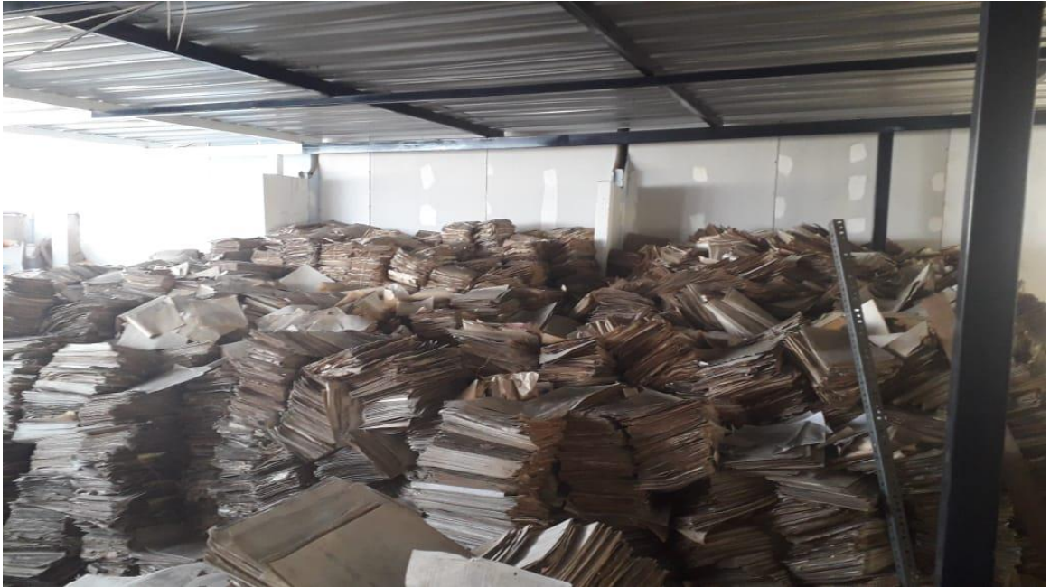
Figura 30: Acumulación de residuos en azotea del hospital Belén de Trujillo
