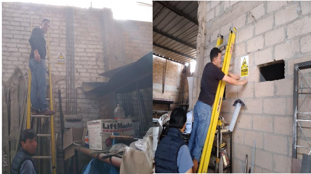
Figura 20: Implementación de señales de advertencia.
