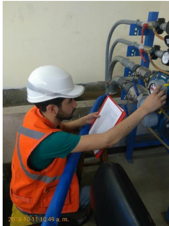
Fotografía 11: Toma de datos, anotación del volumen final del micromedidor.
