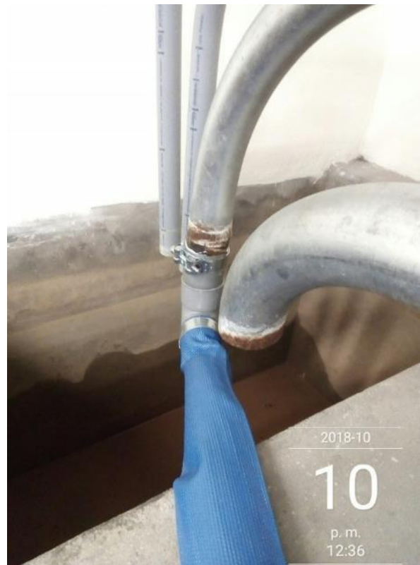
Fotografía 2: Conexión de manga a tubería galvanizada de dos pulgadas del banco de pérdidas de tubería del laboratorio de hidráulica
