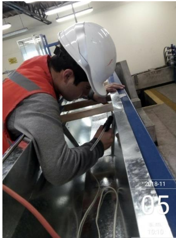
Fotografía 19: Instalación del canal trapezoidal, uso de pegamento para evitar filtración del agua.
