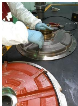
Figura 19. Electro bomba Flygt para mantenimiento preventivo
