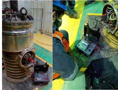
Figura 15. Identificación de Electro bomba sin protección de temperatura
