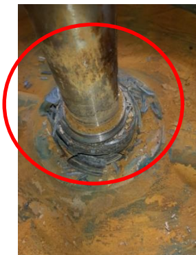
Figura 13. Rotura de Sello Mecánico con presencia de Sedimentos
