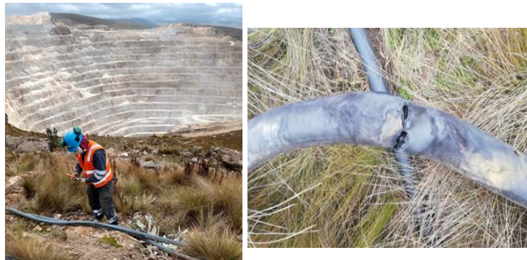
Figura 21. Accidente en cable de alimentación de electrobomba Flygt
