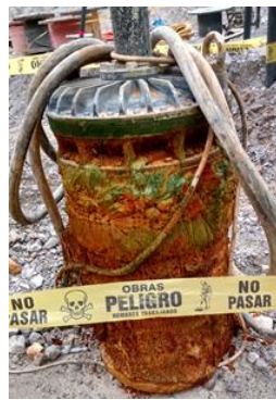
Figura 18. Electro bomba Flygt con altas horas de operación
