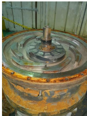
Figura 17. Rotura de Sello Mecánico con presencia de Sedimentos
