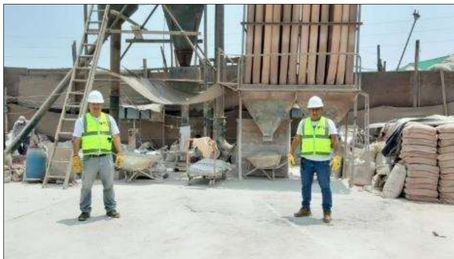
Figura 14: Planta de trituración de escombros, (trituradora mandíbula)
