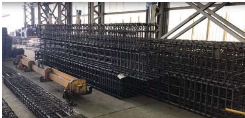
Figura 53: Etiquetado del Pre armadas en la Planta de Pisco
