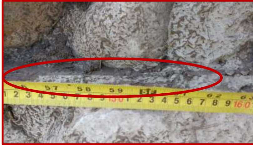
Imagen 13. Muro afectado por corrosión del acero.
