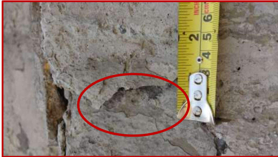
Imagen 8. Muro afectado por fisura.
