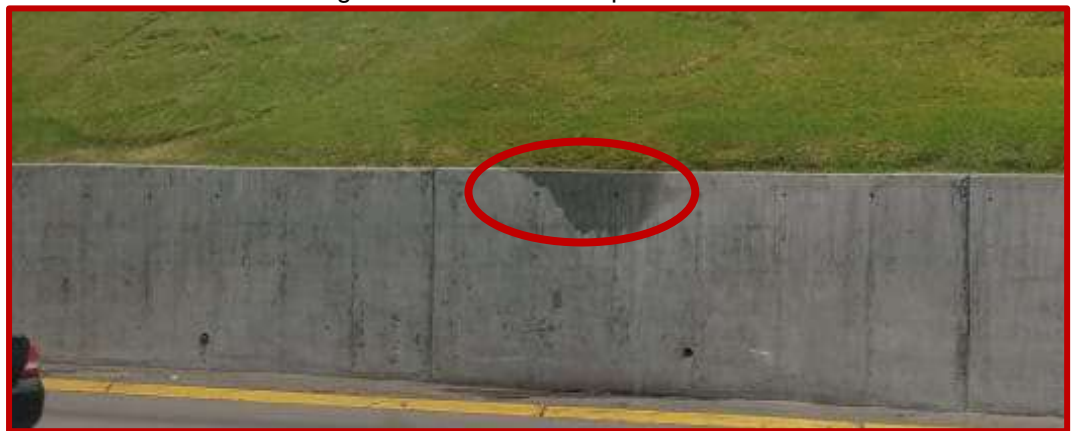
Imagen 15. Muro afectado por humedad.
