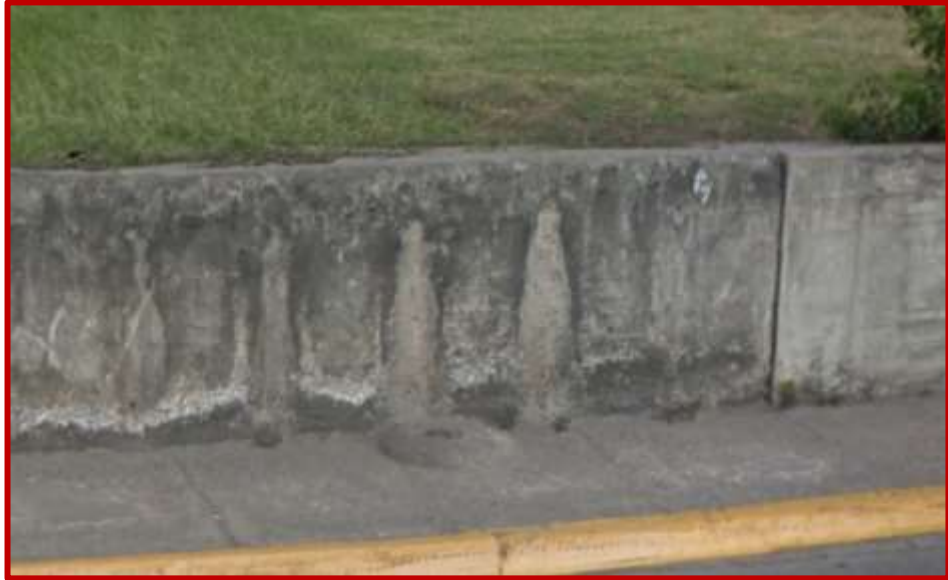
Imagen 3. Muro afectado por eflorescencia.
