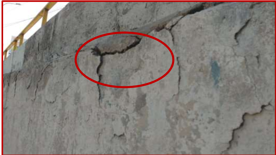
Imagen 10. Muro afectado por desprendimientos.
