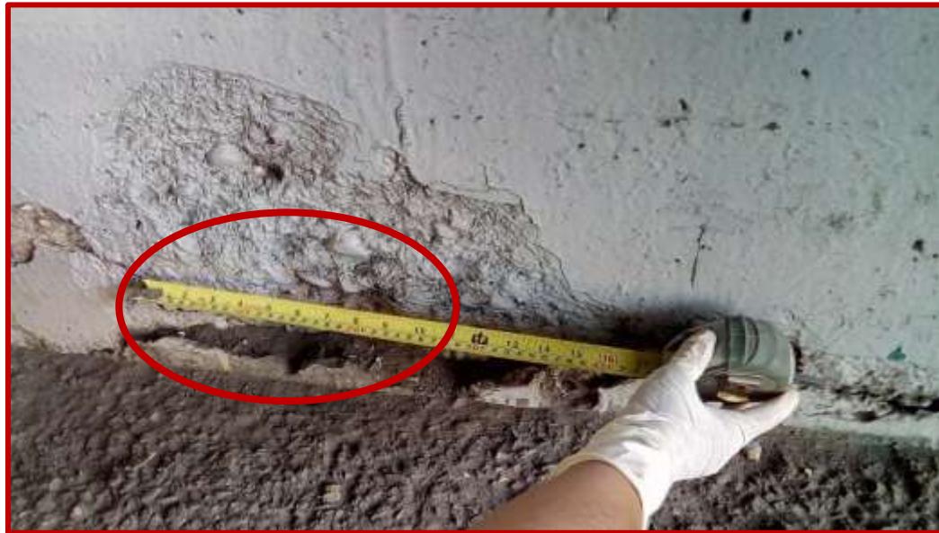
Imagen 7. Muro afectado por desprendimientos
