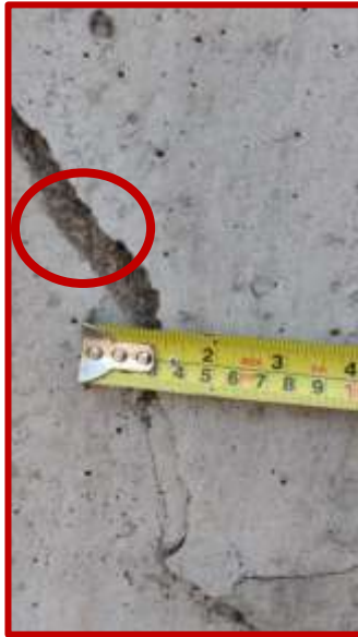
Imagen 11. Muro afectado por Grietas
