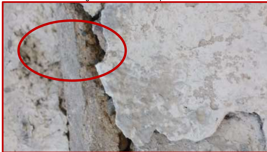
Imagen 6. Muro afectado por erosión
