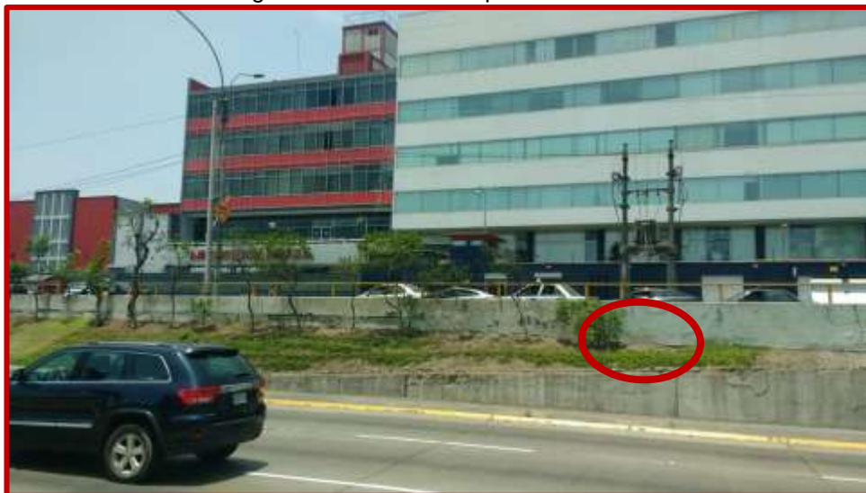
Imagen 9. Muro afectado por eflorescencia
