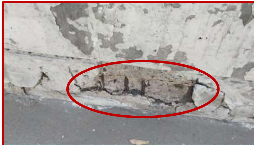
Imagen 12. Muro afectado por corrosión del acero
