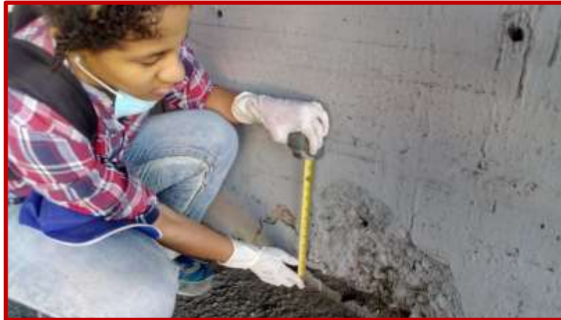
Imagen 14. Muro afectado, medición de cada agente patológico.
