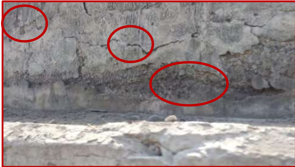
Imagen 5. Muro afectado por desprendimiento y grietas.
