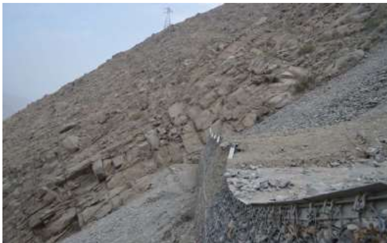
Figura 18: Estado de la barrera dinámica 04 ubicada en la Quebrada Carossio Fuente: Elaboración Propia
