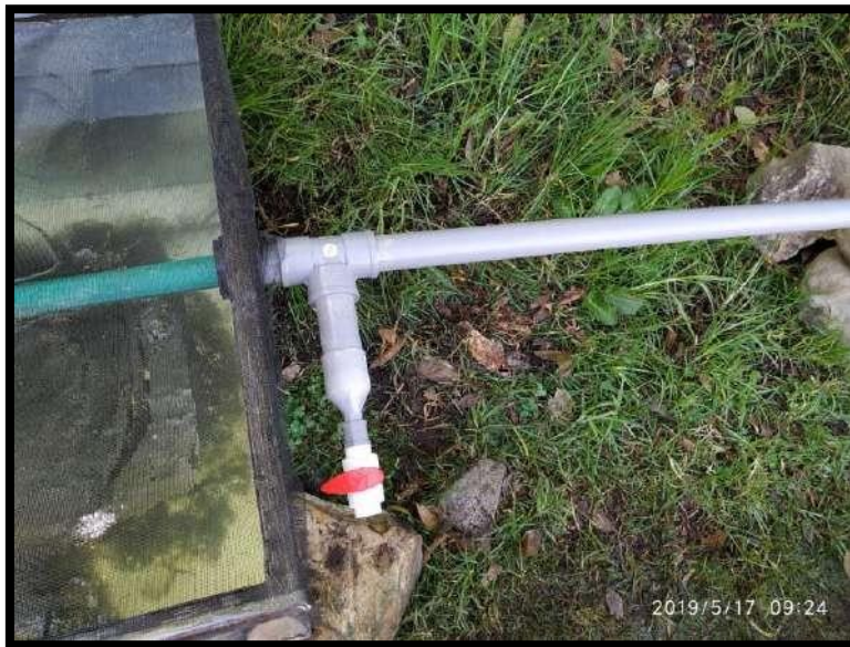
FIGURA 66 Punto de control de muestra Filtro 01
