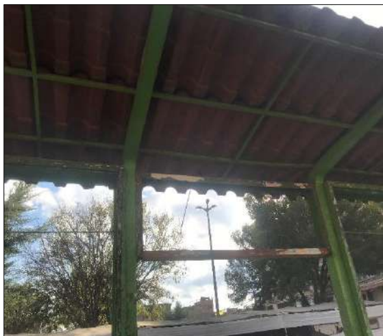
Foto N° 27. Partes de la estructura presenta corrosión.
