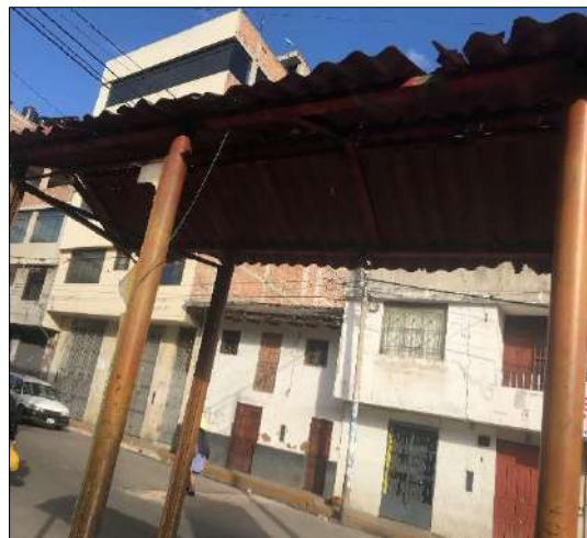
Foto N° 28. Los techos se encuentran en mal estado.
