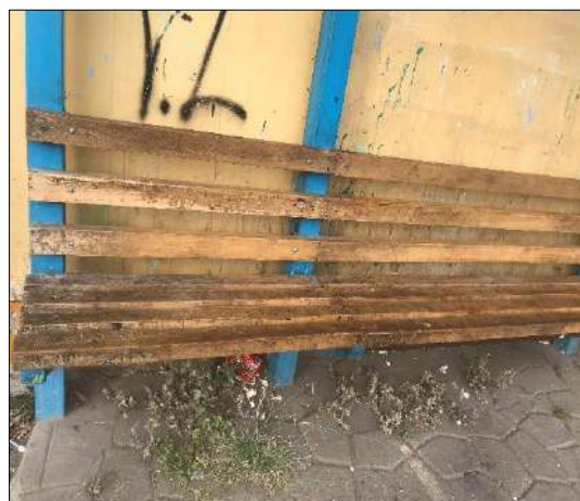
Foto N° 30. Asientos en condiciones antihigiénicas.
