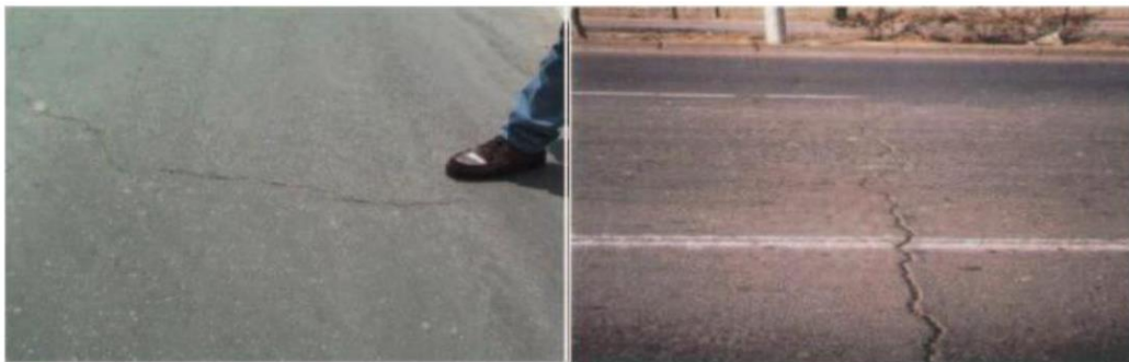
Figura 14. Fisuras y nivel de severidad bajo - alto Fuente: MTC- Manual de conservación vial, 2013.
