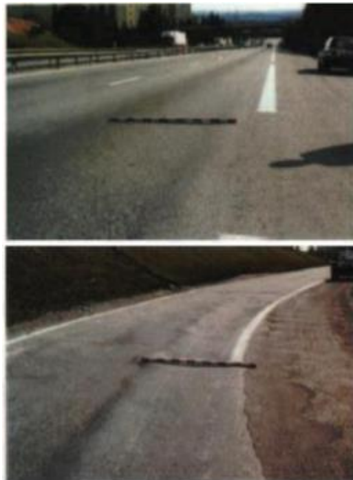
Figura 10. Ahuellamiento y nivel de severidad bajo –medio-alto Fuente: MTC- Manual de conservación vial, 2013.
