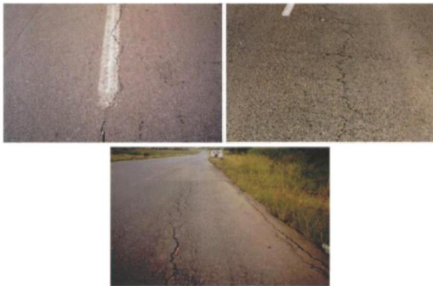
Figura 9. Fisuras longitudinales y niveles de severidad bajo-medio-alto Fuente: MTC- Manual de conservación vial, 2013.
