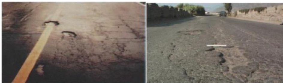
Figura 13. Baches y nivel de severidad bajo-medio-alto
