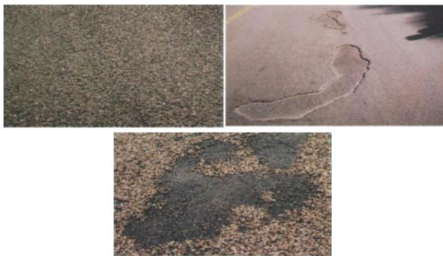
Figura 12. Peladuras superficiales y niveles de severidad bajo-medio-alto Fuente: MTC- Manual de conservación vial, 2013.
