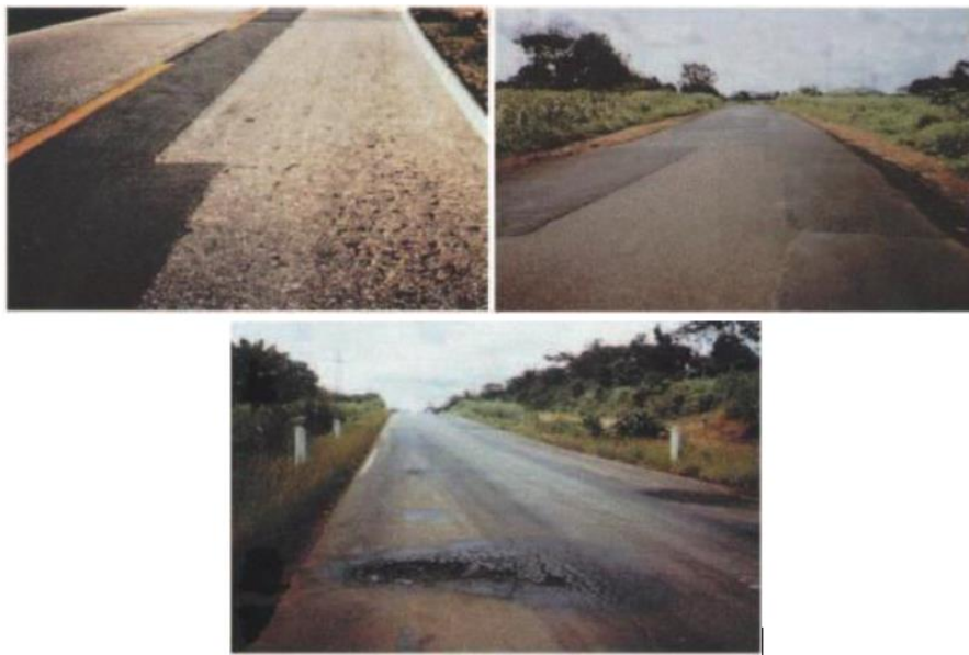
Figura 11. Reparaciones o parchados y nivel de severidad bajo-medio-alto Fuente: MTC- Manual de conservación vial, 2013.
