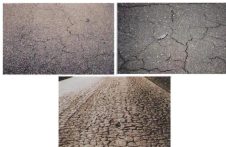
Figura 8. Piel de cocodrilo y niveles de severidad bajo-medio-alto Fuente: MTC- Manual de conservación vial, 2013.
