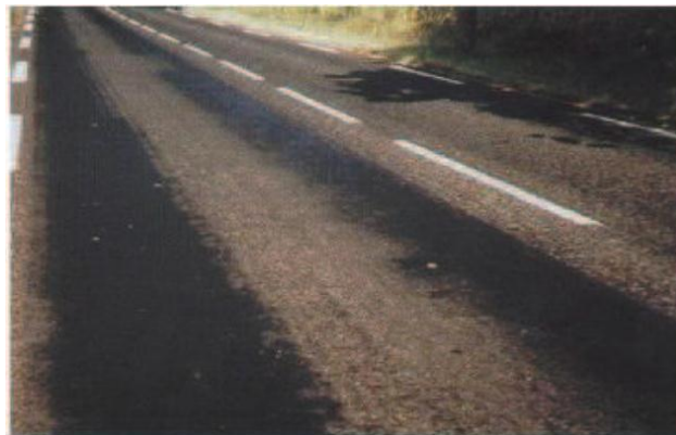
Figura 15. Exudaciones Fuente: MTC- Manual de conservación vial, 2013
