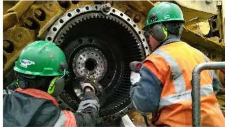
Instalación del plate central del mando final, luego de haber instalado el retén
