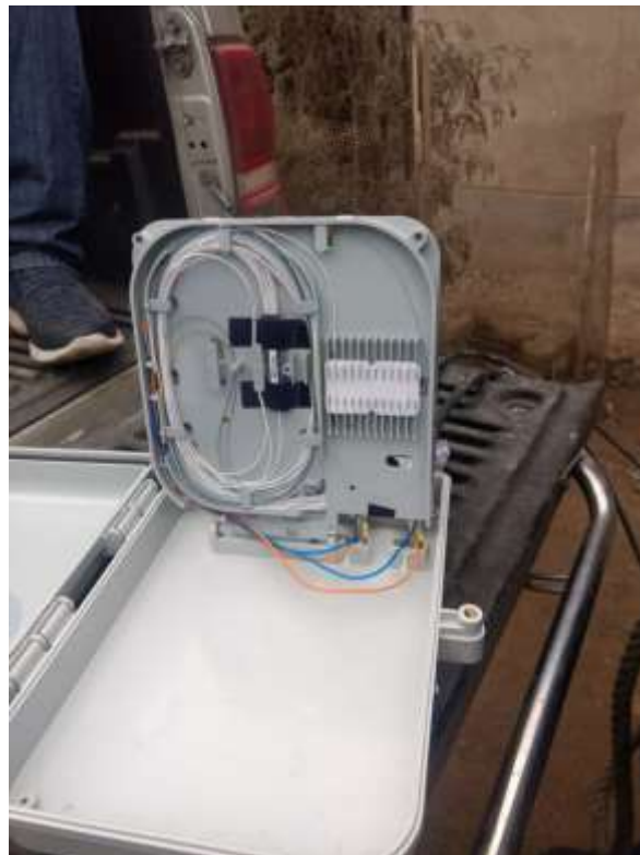
Figura N° 58 Caja de distribución fibra óptica
