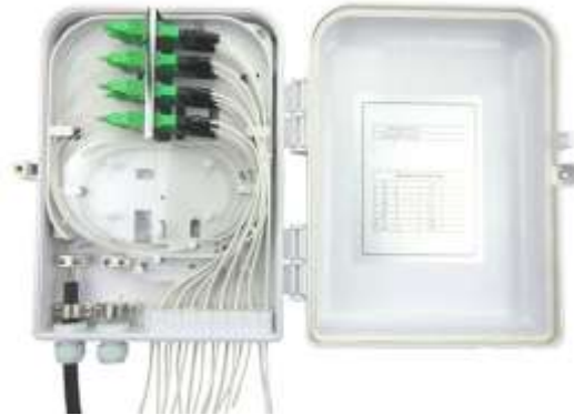
Figura N° 45 Caja de distribución
