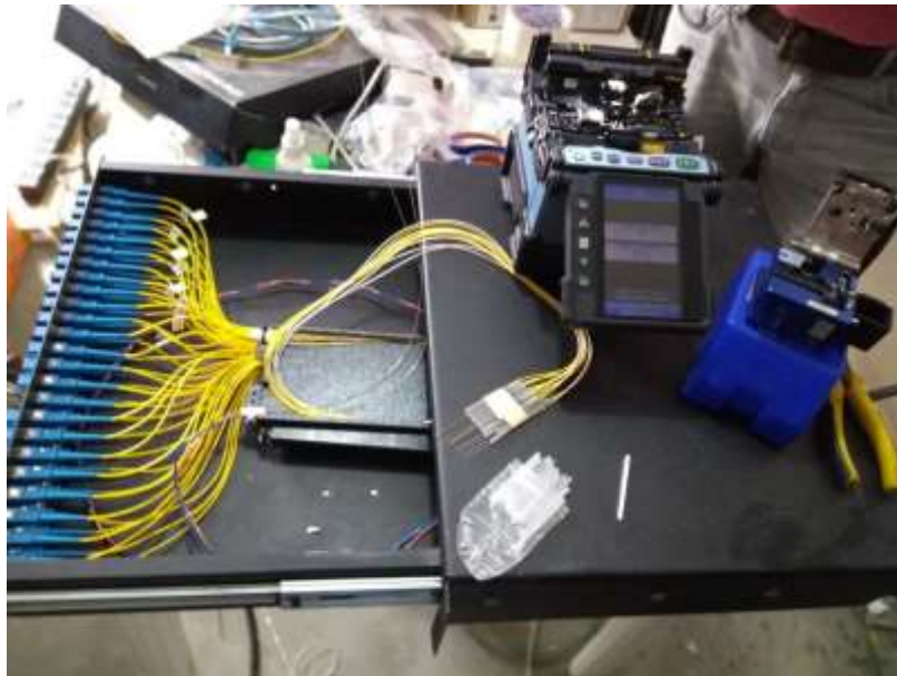
Figura N° 54 Armario de distribución óptica ODF
