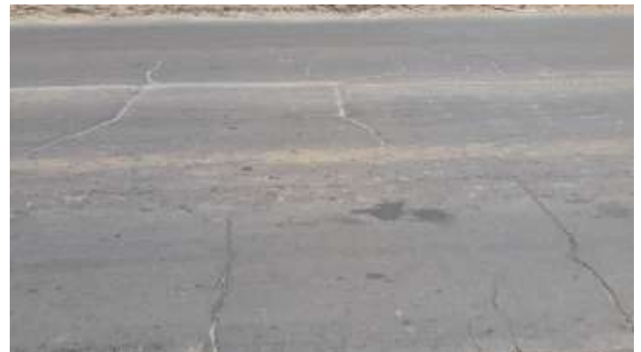
Grietas Longitudinales y Transversales
