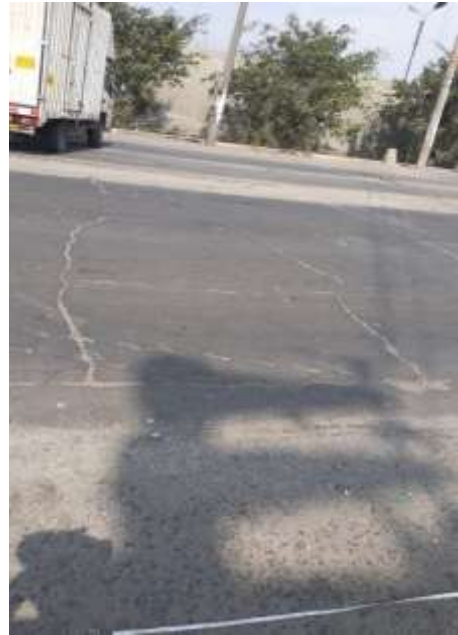
Grietas Longitudinales y Transversales
