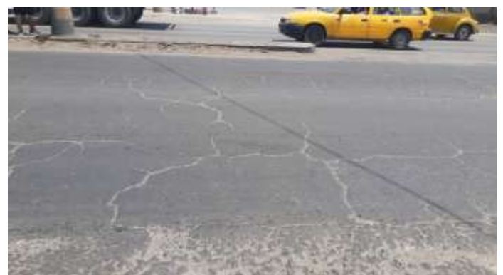
Grietas Longitudinales y Transversales
