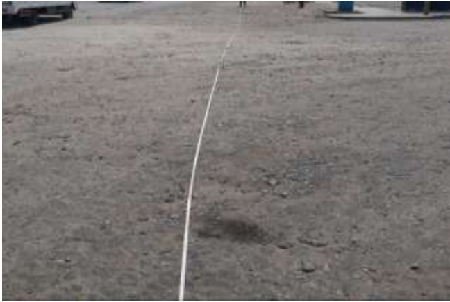
Muestra 28 Desprendimiento de agregados
