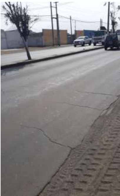
Grietas Longitudinales y Transversales
