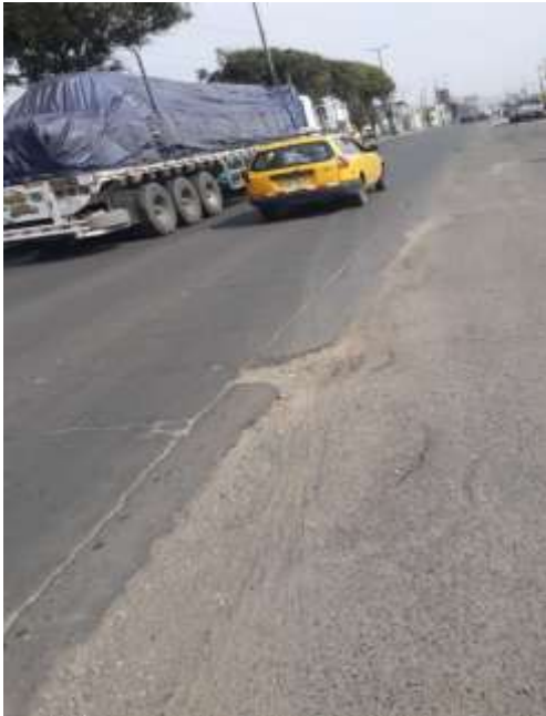
Grieta de borde
