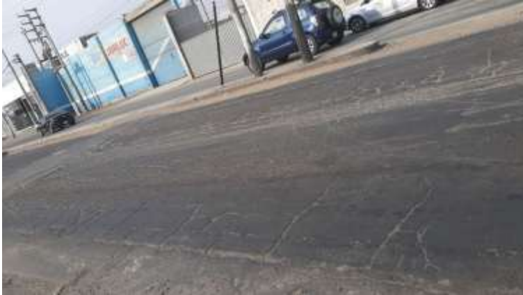
Muestra 19 Grietas Longitudinales y Transversales
