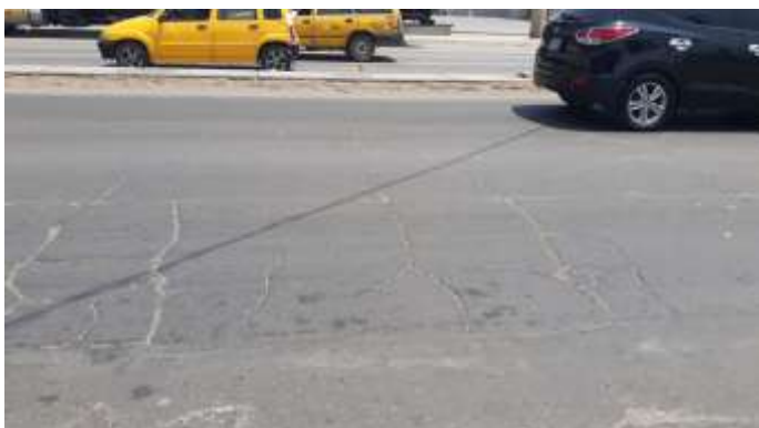
Muestra 27 Grietas Longitudinales y Transversales
