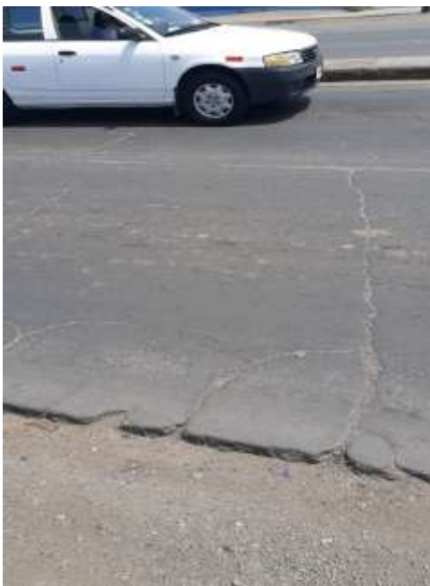
Grietas Longitudinales y Transversales
