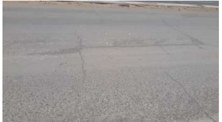
Grietas Longitudinales y Transversales
