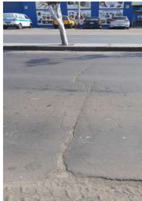
Grietas Longitudinales y Transversales
