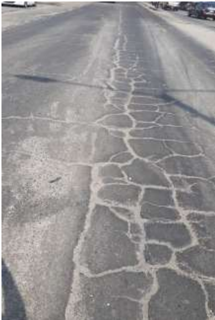
Muestra 20 Grietas Longitudinales y Transversales
