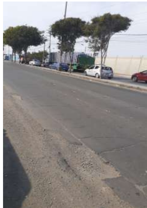
Grieta de borde
