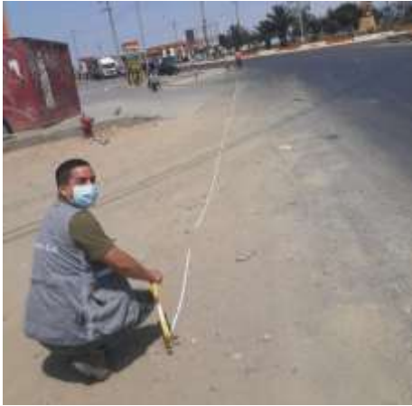
Inicio de tramo
