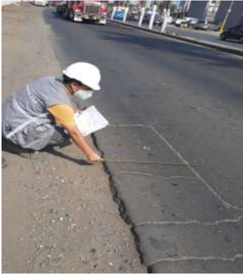
Levantamiento de grieta
