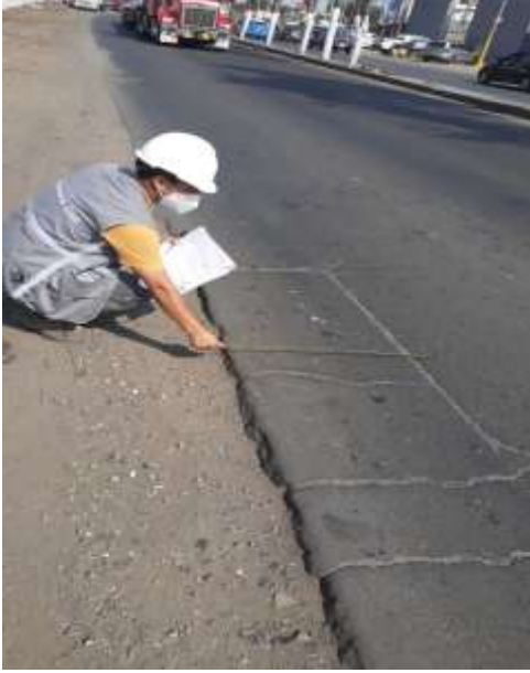
Grietas Longitudinales y Transversales
