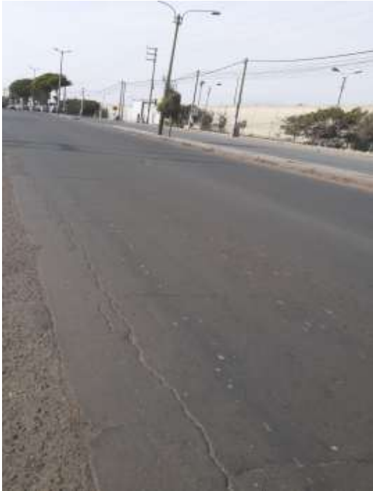
Muestra 17 Grietas Longitudinales y Transversales
