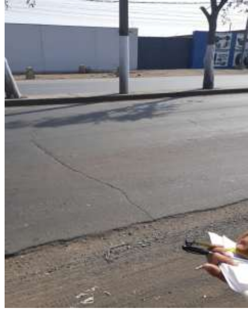
Grietas Longitudinales y Transversales
