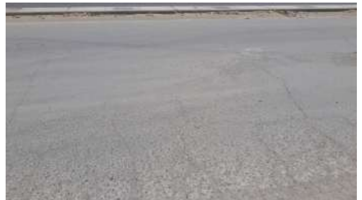
Grietas Longitudinales y Transversales
