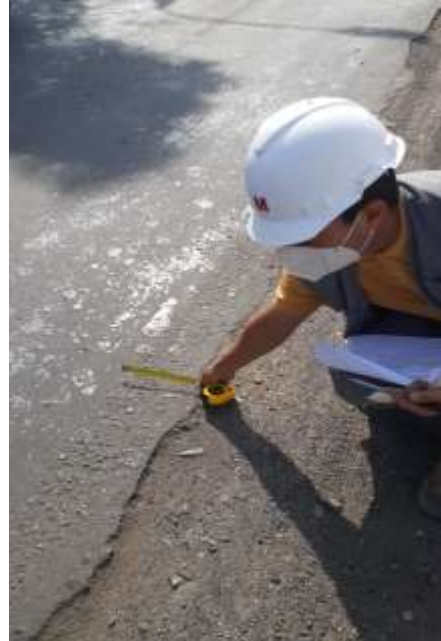
Desprendimiento de agregados
