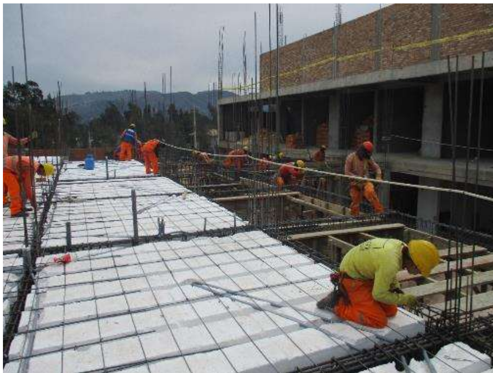
Fotografía 39. Avance de trabajos en la partida de acero de refuerzo en losas aligeradas.
