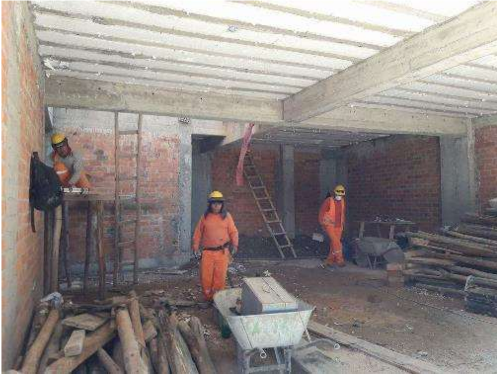
Fotografía 21. Avance de trabajos en la partida de tarrajeo de desencofrado en losas aligeradas.
